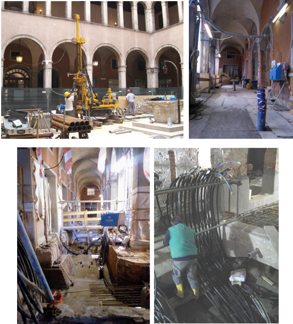
Figura 8: Esempio di realizzazione di sonde geotermiche verticali all'interno di un edificio storico, sotto il porticato del cortile interno.
