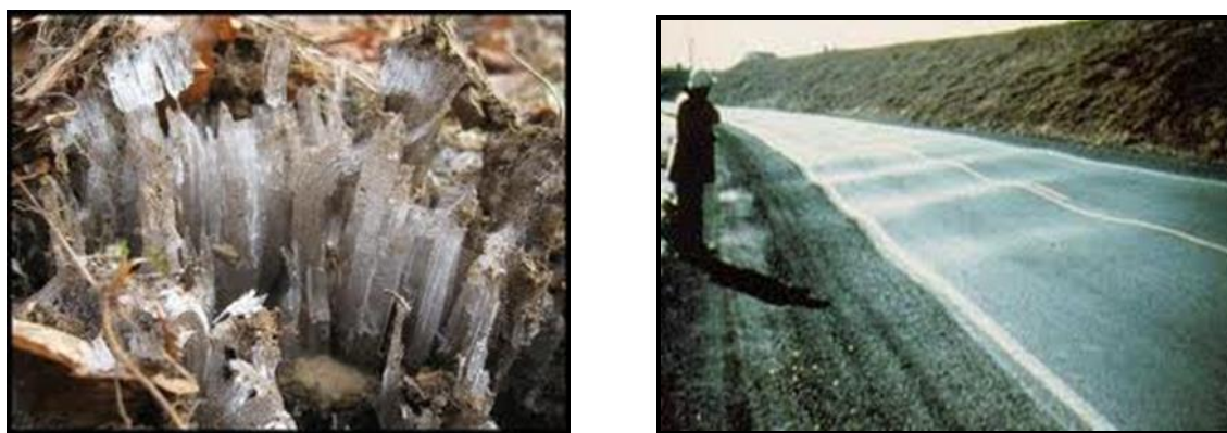
Figura 12: Fenomeno del frost heave e un esempio di danneggiamento del piano stradale dovuto alle deformazioni stagionali indotte nei primi strati di terreno a causa del fenomeno ciclico di gelo e disgelo.
