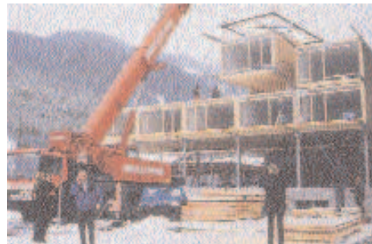
Fasi di realizzazione del nuovo corpo di fabbrica di un hotel a Bezau. (Detail 04/2001).
