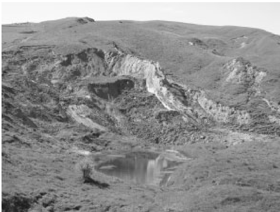
Fig. 4 — Zona di distacco dello scorrimento rotazionale a sud della casa Cantoniera di Km 47.
