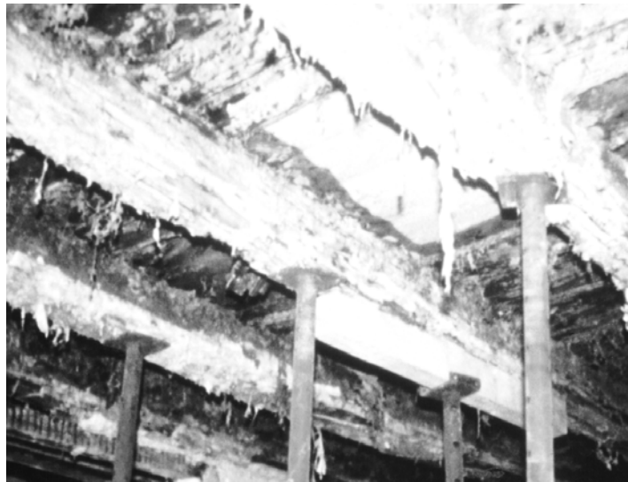
Bild 5 Vom Hausschwamm befallene Holzbalkendecke [11]
