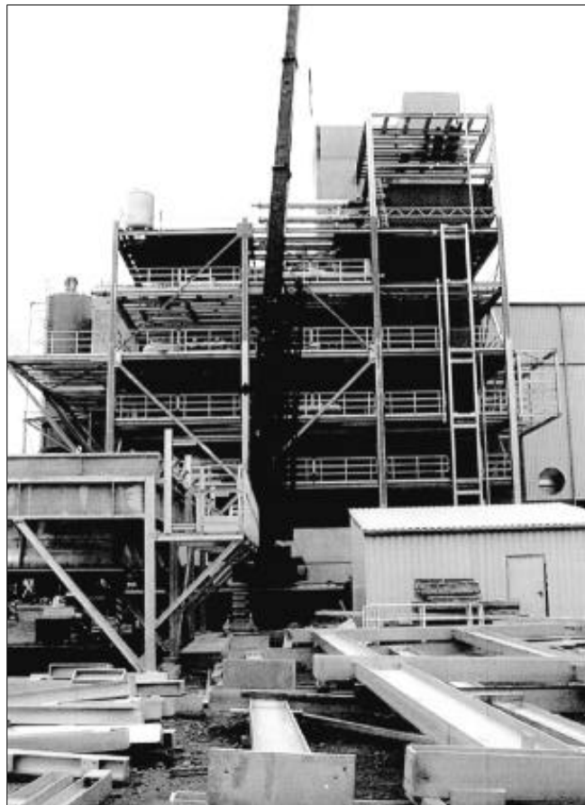
Bild 3 Reduzieranlage am 29. Juni 2000
