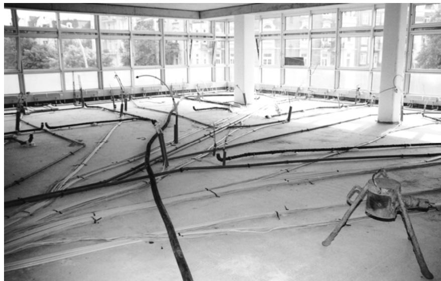
Bild 3 Rohrwirrwarr auf der Betonplatte [6]
