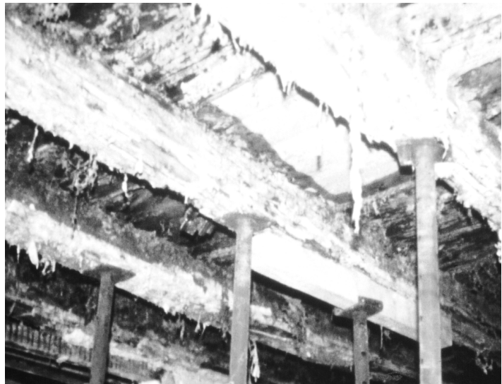
Bild 5 Vom Hausschwamm befallene Holzbalkendecke [11]
