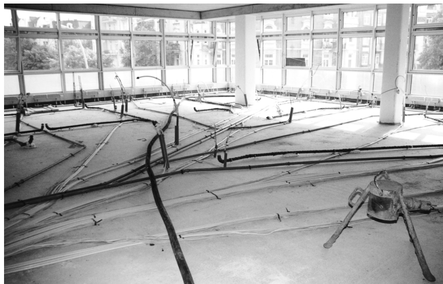
Bild 3 Rohrwirrwarr auf der Betonplatte [6]
