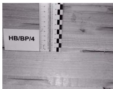
Abb.5-9: Teilweise verdeckte Profilierungen infolge gebogener Lamellen
