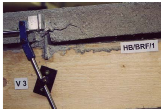
Abb.5-54: Ablösen eines Betonkeils vor dem Flachstahlschloss
