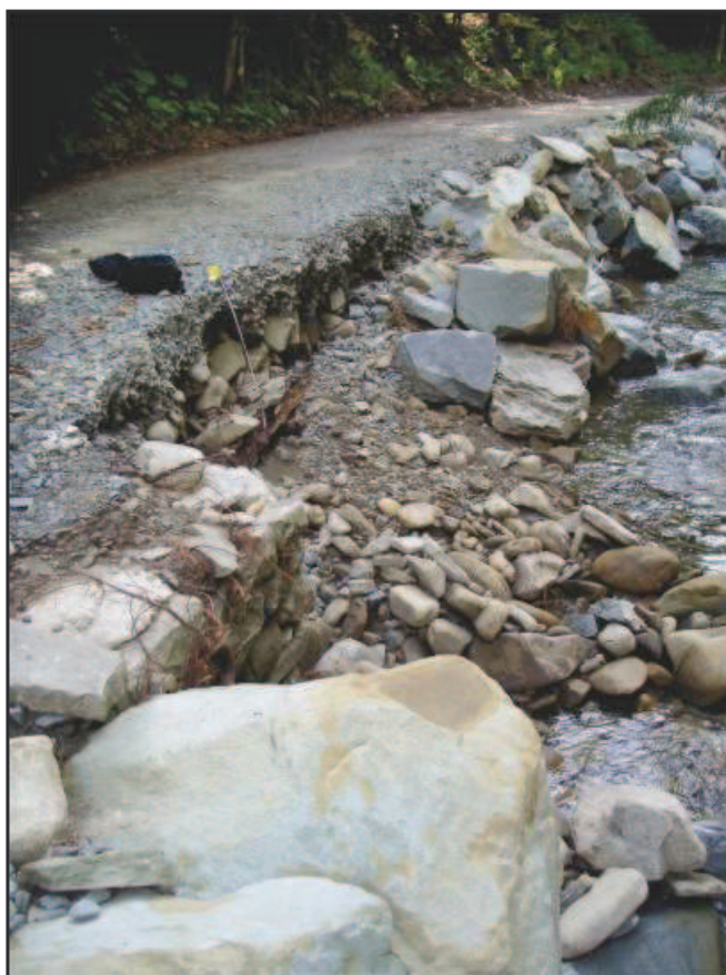
Ryc. 9. Podcięcie erozyjne drogi Źródło: P. Franczak.
