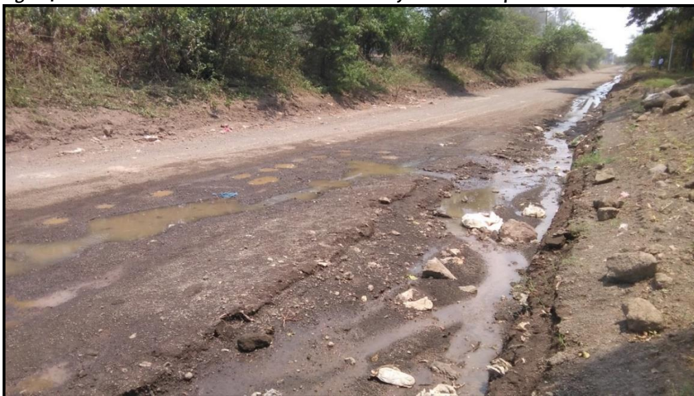
Fig. 2.4.1.2: Deterioro a causa de la erosión del suelo y la lluvia en época de invierno.
