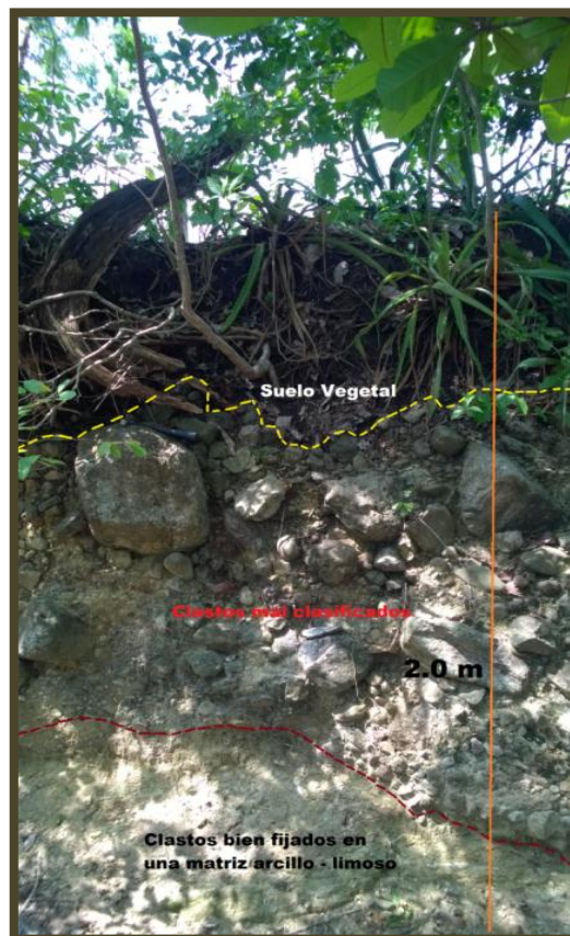
Foto No. 3-10. Representación de una matriz arcillo – limoso con clastos mal clasificados y con clastos muy consolidados en la matriz, con coordenadas UTM N 1335.100, E 668.400
