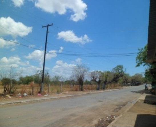
Imagen No. 55 Cableado eléctrico en el sitio
