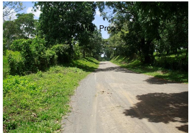
Ilustración 29. Vía de acceso sin revestimiento
