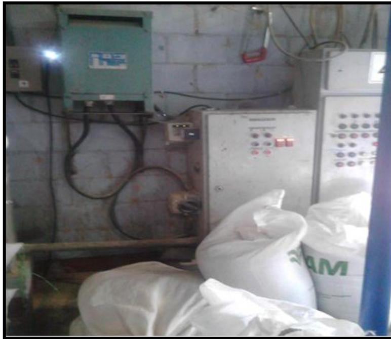
Material de propagación de fuego cerca de Panel Eléctrico
