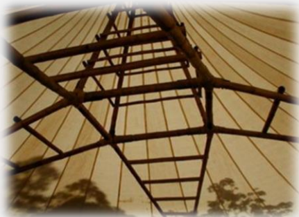
Imagen No. 20. Vistas interna estructura de techo Centro de visitas Fuente: http://tripadvisor.com.mx
