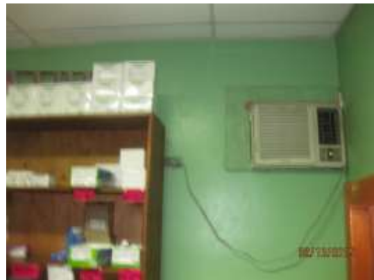
Ilustración 10: Aire acondicionado del área de Farmacia
