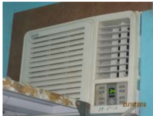
Ilustración 18: Aire acondicionado de Bodega de Insumos Médicos
