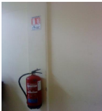
Extintor y su señalización.
