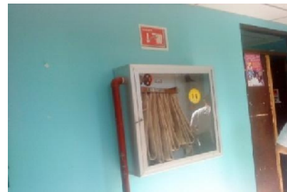
Hidrante y su señalización.
