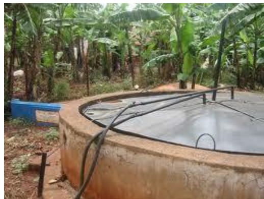
Figura 6. Biodigestor en zonas rurales
