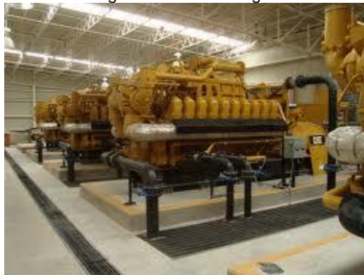
Figura 8. Motor a Biogás
