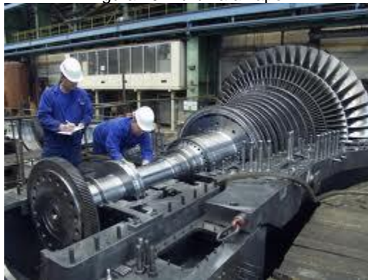
Figura 10. Turbina a vapor
