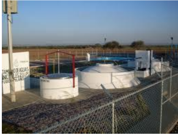
Figura 5. Biodigestor de aguas residuales
