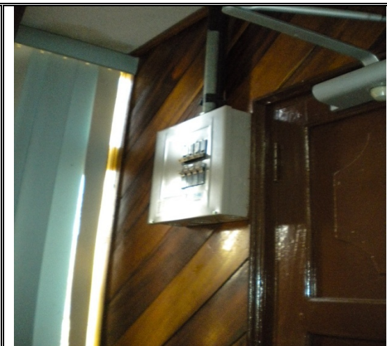
Caja de Electricidad
