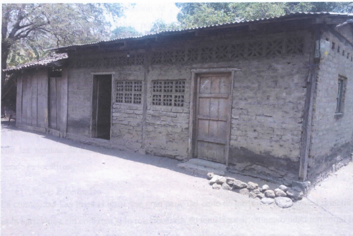
Imagen N° 7: Vivienda de la comunidad Las Pilas sector “La Loma Blanca” donde se refleja el nivel alcanzado por el lahar ocurrido en octubre del año 2014.
