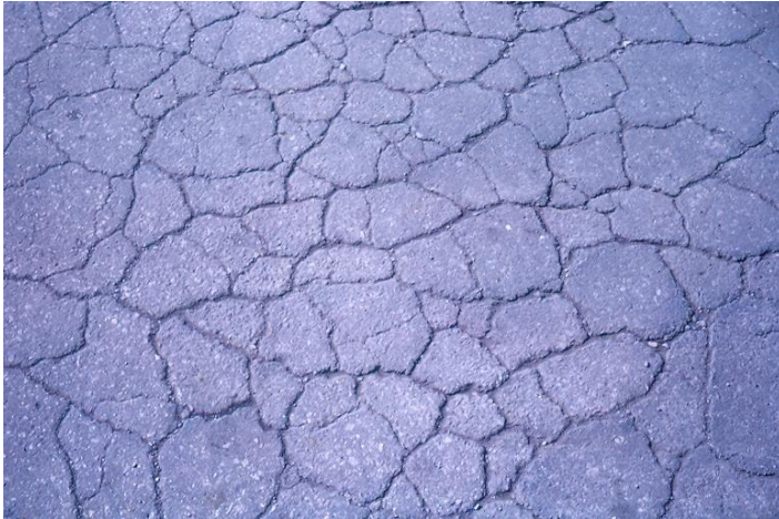
Figura 9-1 - Grietas o piel de cocodrilo en el pavimento flexible.
