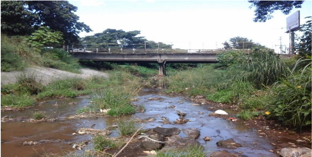
Figura 23: Fotos tomadas en el levantamiento topográfico del cauce natural en estudio. Fuente: elaboración propia, septiembre 2014.
