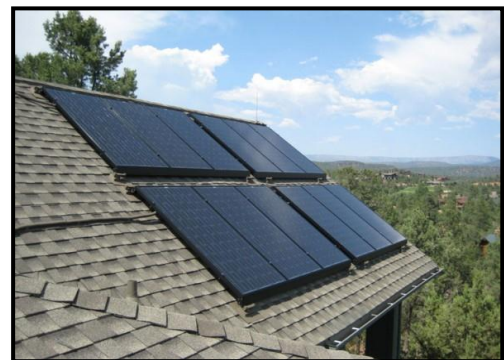
Imagen N° 13. Paneles solares en techo Fuente: www.asonalosolar.com
