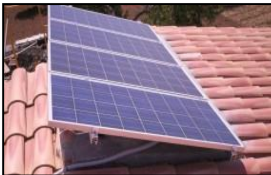
Imagen N° 12. Paneles solares en techo Fuente: www.asonalosolar.com
