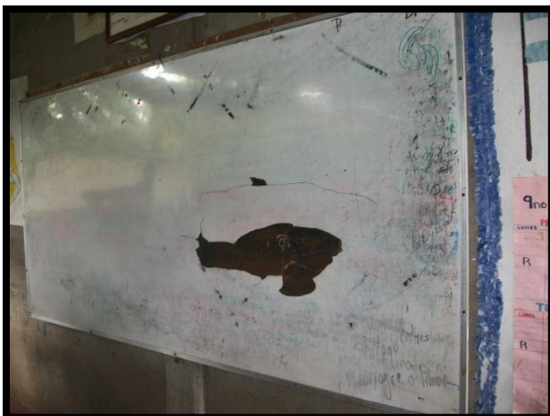
Mal estado de las pizarras
