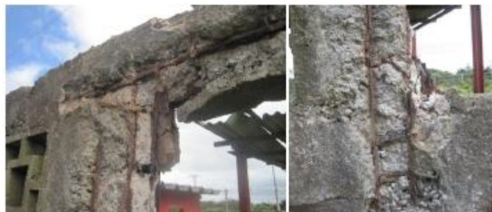
Ilustración N° 20. Vivienda abandonada expuesta a la oxidación.
