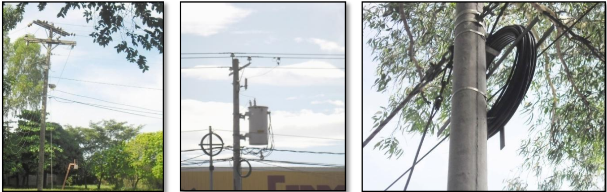
Foto No. 24 Postes de tendido eléctrico y líneas telefónicas en el sitio.
