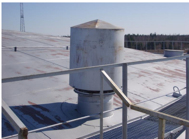
Рис. 4. Вентиляционный патрубок ОП-500.
