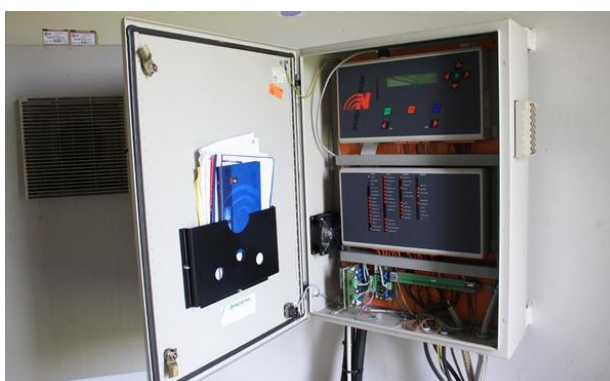
Рисунок 12.18 – Контроллер состояния ветрогенератора Nordtank 500
