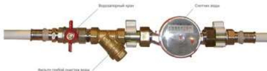
Рисунок 9 - Счетчик воды в квартире
