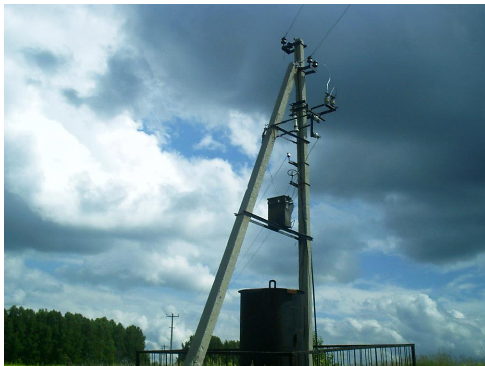
Рисунок 14. Преобразователь катодной защиты, установленный в бочке сваренной из трубы диаметром 1200 мм.
