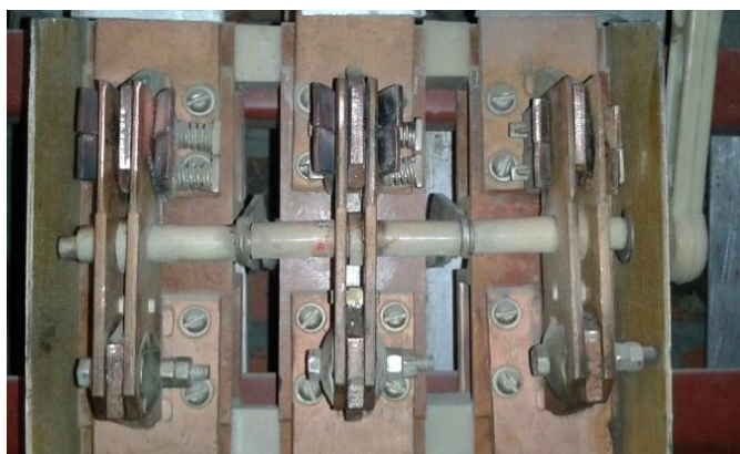
Рис. 3. Рубильник вводной секции
