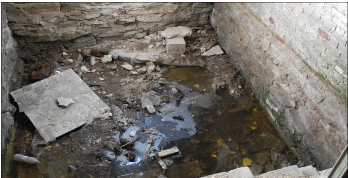
Рис. 3. Вода в подвале здания вокзала на ноябрь 2013 г.
