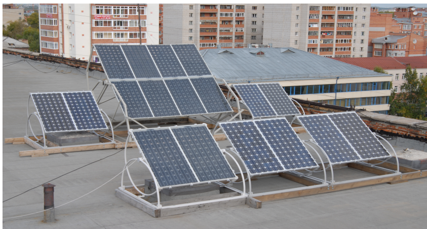
Рис. 2. Автономный источник электропитания на основе фотоэлектрических преобразователей АИЭП-5000
