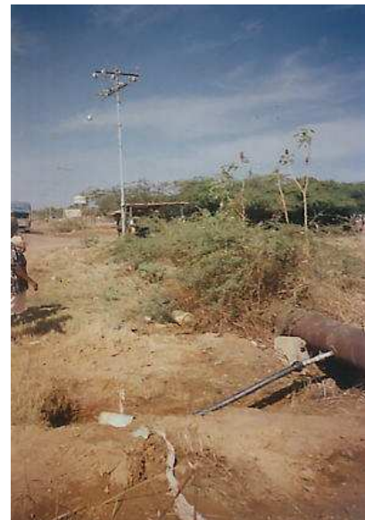
Photographie n°5 – 6 Prise illégale sur l'infrastructure du prestataire et réseau précaire dans le quartier à la périphérie de Maracaibo ( barrio Brisas del Norte )
