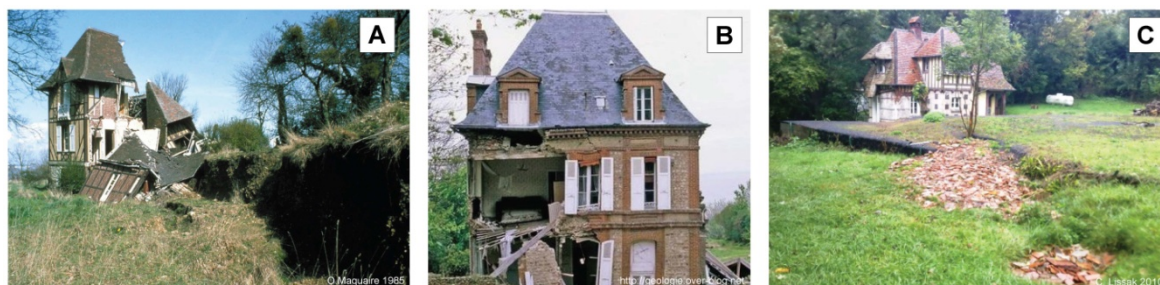
(A) et (B), dégâts structurels sur le bâti suite aux événements de 1982 et (C), fracture ouverte apparue suite à la réactivation de 2001.
