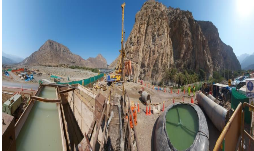
Figura 60. Montaje de la Planta de lodos, preparación de la plataforma de trabajo
