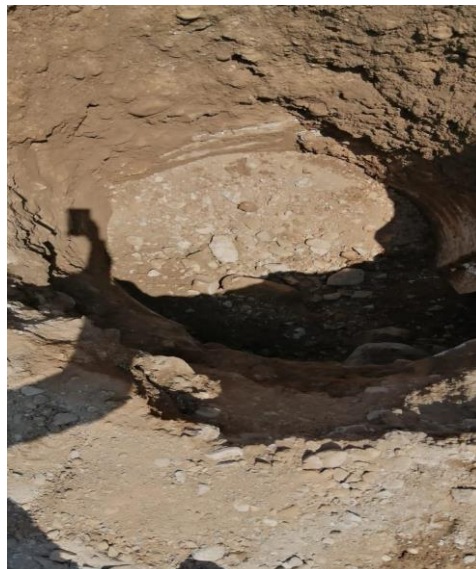
Figura 7. Desmoronamiento y caída de las paredes laterales de la excavación del pilote
