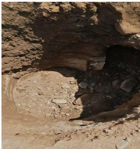
Figura 5. Desmoronamiento y caída de las paredes laterales de la excavación del pilote
