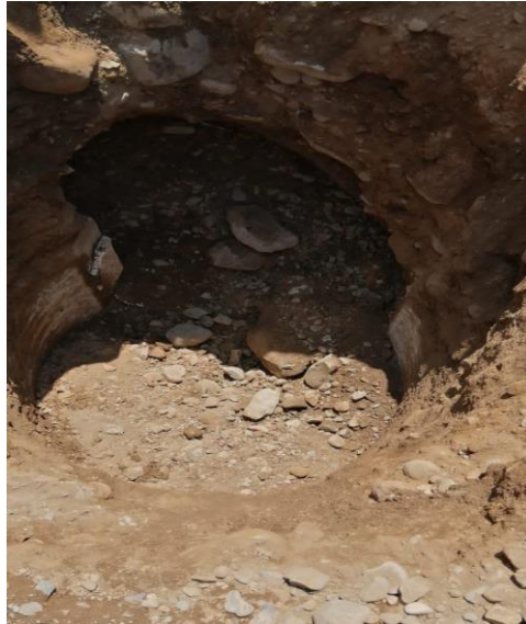
Figura 6. Desmoronamiento y caída de las paredes laterales de la excavación del pilote
