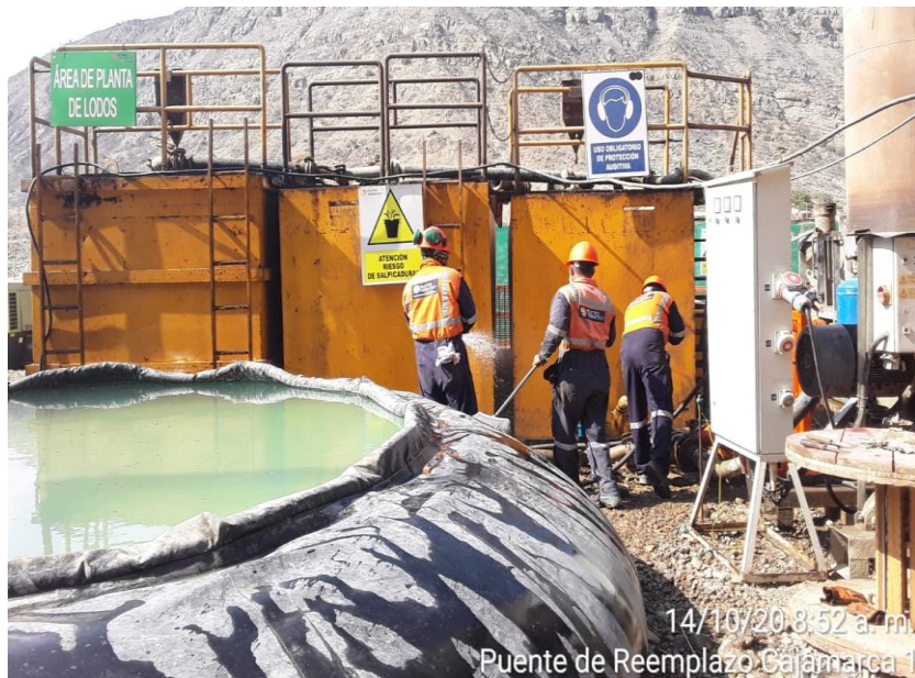
Figura 86. Equipamiento y preparación de la Planta de Lodos
