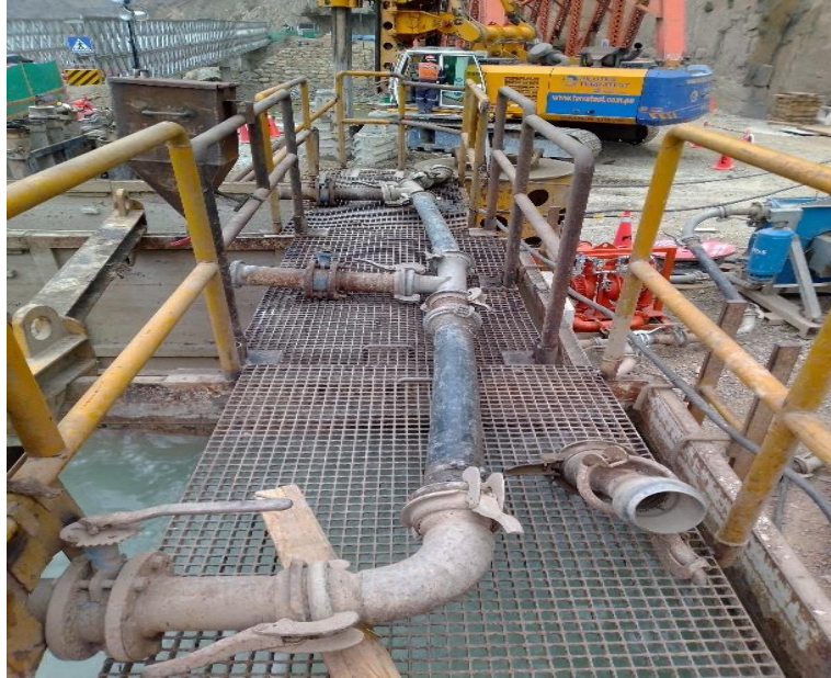
Figura 85. Equipamiento y preparación de la Planta de Lodos
