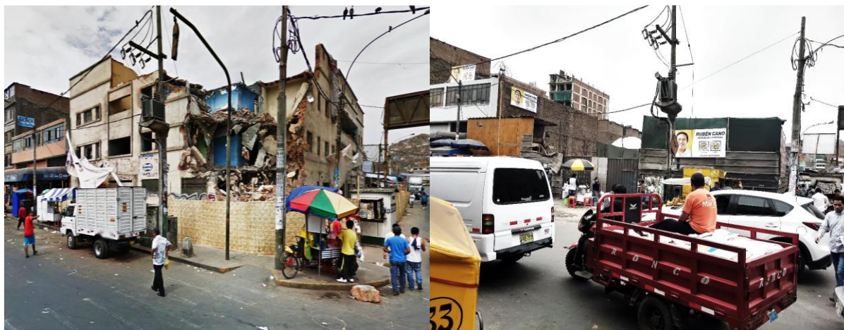
Foto 16: Captura de vista fotográfica del cruce de las avenidas Isabel La Católica y Aviación. Edificación que fue demolida en el año 2013. (Izq.) Vista fotográfica del cruce de las avenidas Isabel La Católica y Aviación. Lote que actualmente se encuentra excavado para una futura edificación. (Der.)
