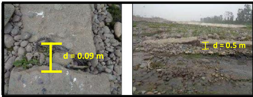
Figura 16.- Pantalla numero 34 colapsada (Informe Trinity Fuente: Informe Trinity, 2017, p. 35
