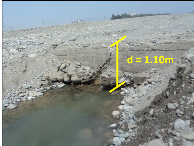
Figura 6.- Vista de pantalla de infiltración con rajadura en el total de su espesor. Nótese las hendiduras en la corona.
