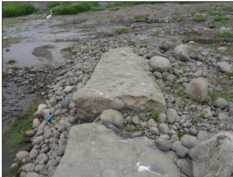
Figura 58: se aprecia los restos de una pantalla de infiltración con asentamiento diferencial y fracturada.
