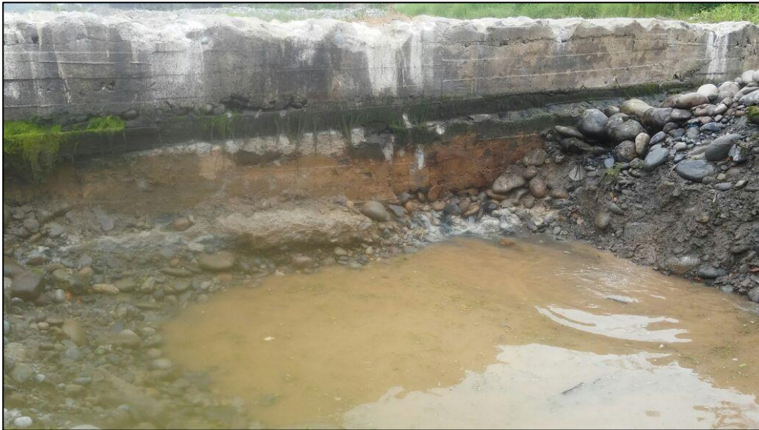
Figura 37.- vista de pantalla de infiltración afectada por hendiduras en la parte superior y cimentación con presencia de bolonería y sin rastros de conglomerado de concreto.
