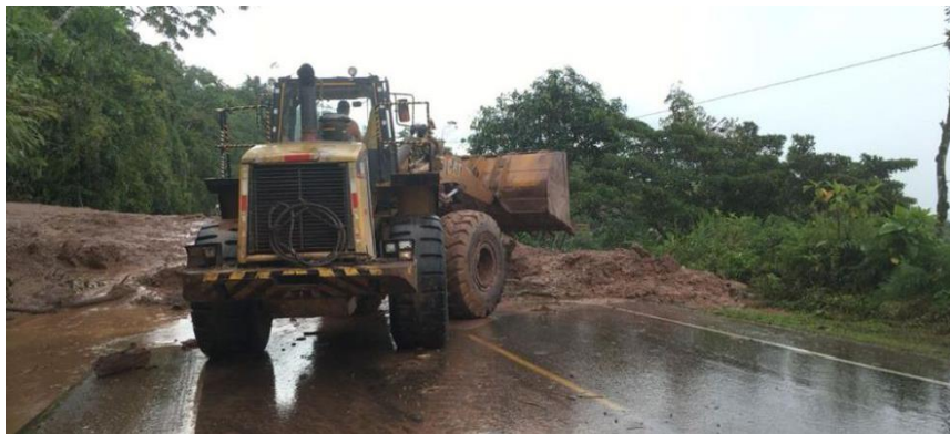
Figura N° 10: Derrumbes mantienen bloqueadas 8 carreteras en el país (2019).
