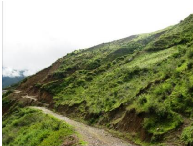
Figura N° 137: Zona crítica progresiva 3+240.
