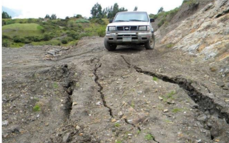
Figura N° 33: Reptación de suelos en Sihuas, Ancash. (2014).
