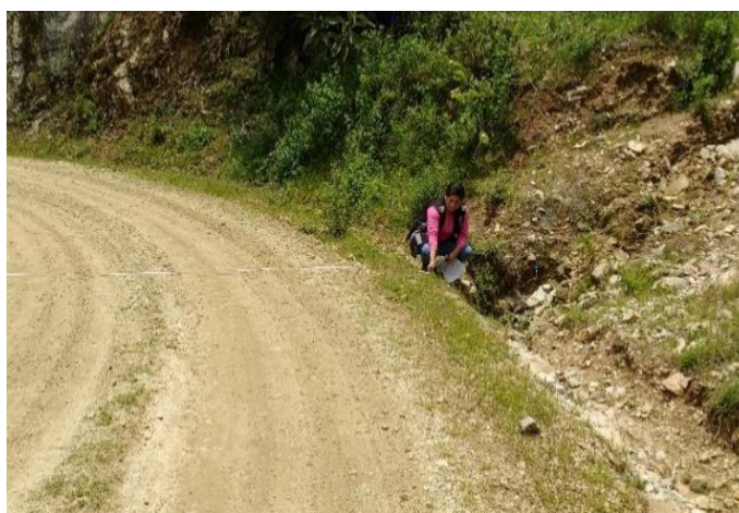
Figura N° 123: Cunetas obstruidas por deslizamiento en la progresiva 01+210.
