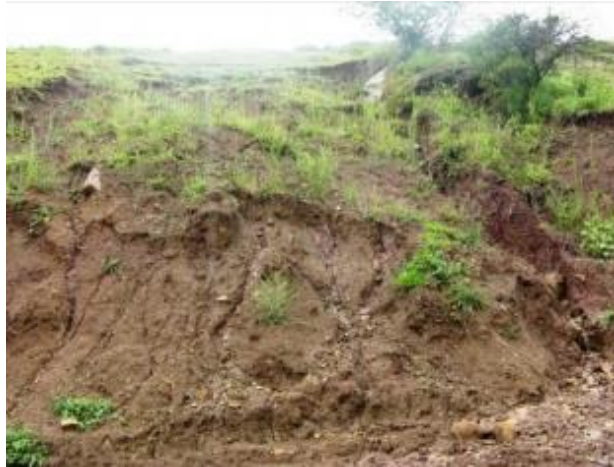
Figura N° 135: Zona crítica progresiva 2+060.
