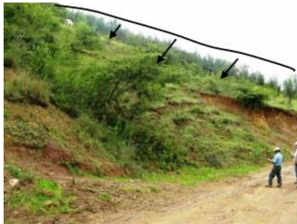
Figura N° 136: Zona crítica progresiva 2+180.
