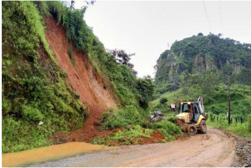
Figura N° 19: Deslizamiento de talud.
