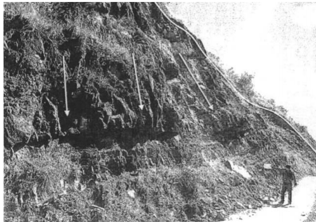
Figura N° 112: Sector crítico km 5+680.
