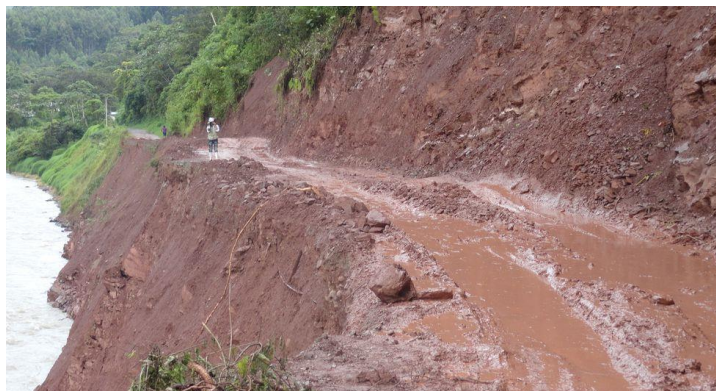
Figura N° 32: Deslizamiento en carretera vecinal en Pozuzo, Oxapampa (2015).
