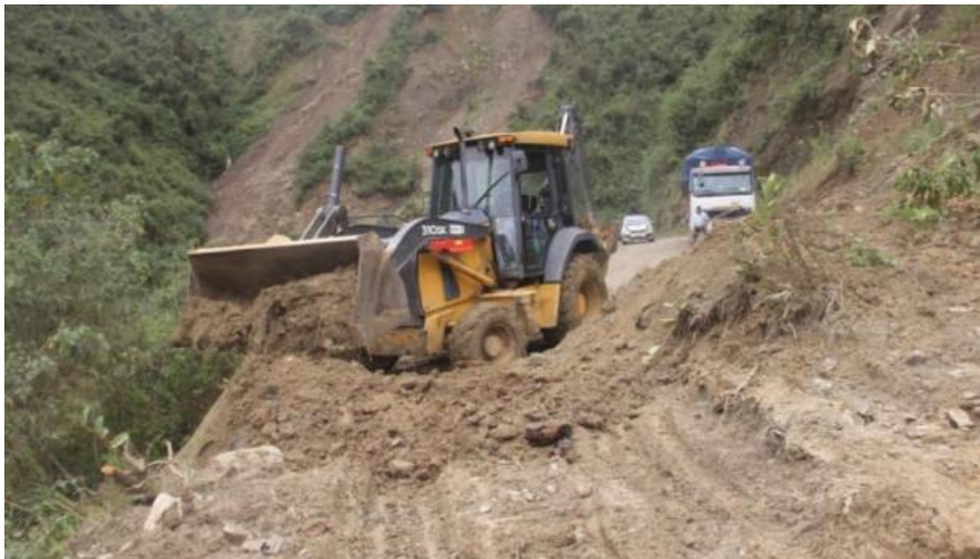
Figura N° 26: Deslizamiento en camino vecinal en Chinchao y Pillao (2019).
