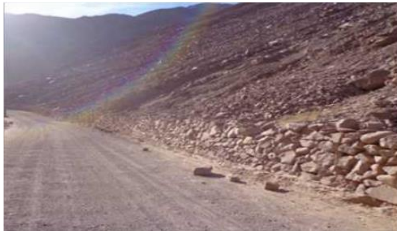
Figura N° 128: Zona crítica progresiva 17+320.
