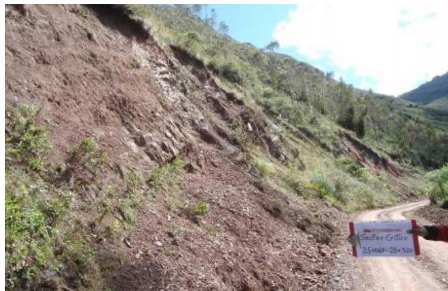
Figura N° 118: Sector crítico km 25+060.
