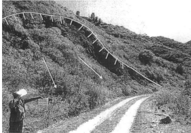
Figura N° 119: Sector crítico km 25+640.
