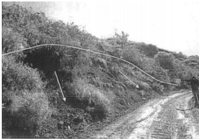
Figura N° 120: Sector crítico km 26+450.
