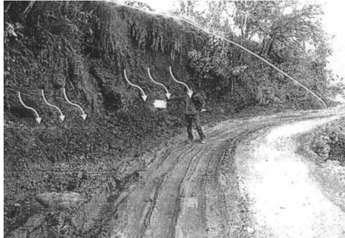
Figura N° 113: Sector crítico km 13+860.
