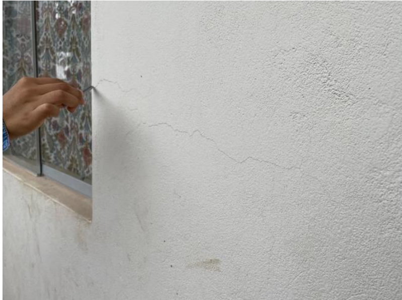
Figura 40: Pared con fallas estructurales, que se unen con los vanos de la vivienda de interés social.
