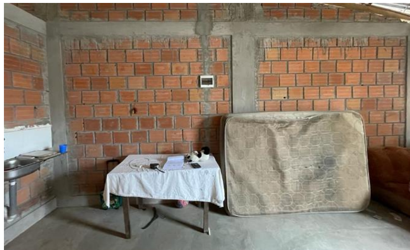
Figura 39: Verificación de estructuración. Las vigas no cumplen con las dimensiones mínimas.
