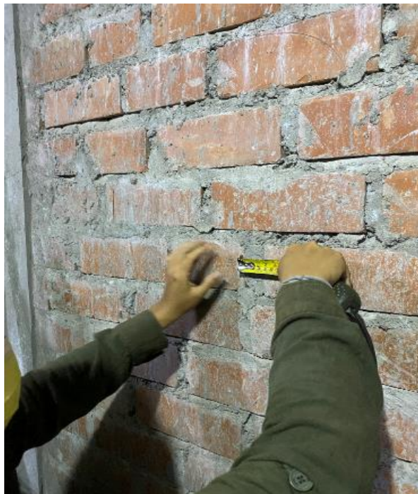
Figura 41: Falla en colocación de mortero, mayor de 1.5cm.
