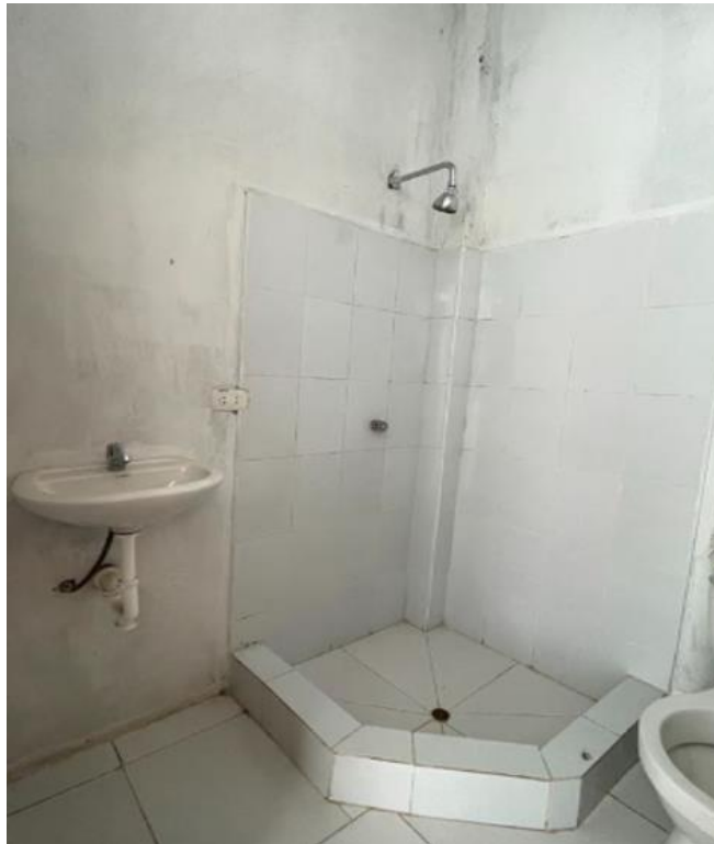
Figura 38: Falla de ubicación de tomacorriente.
