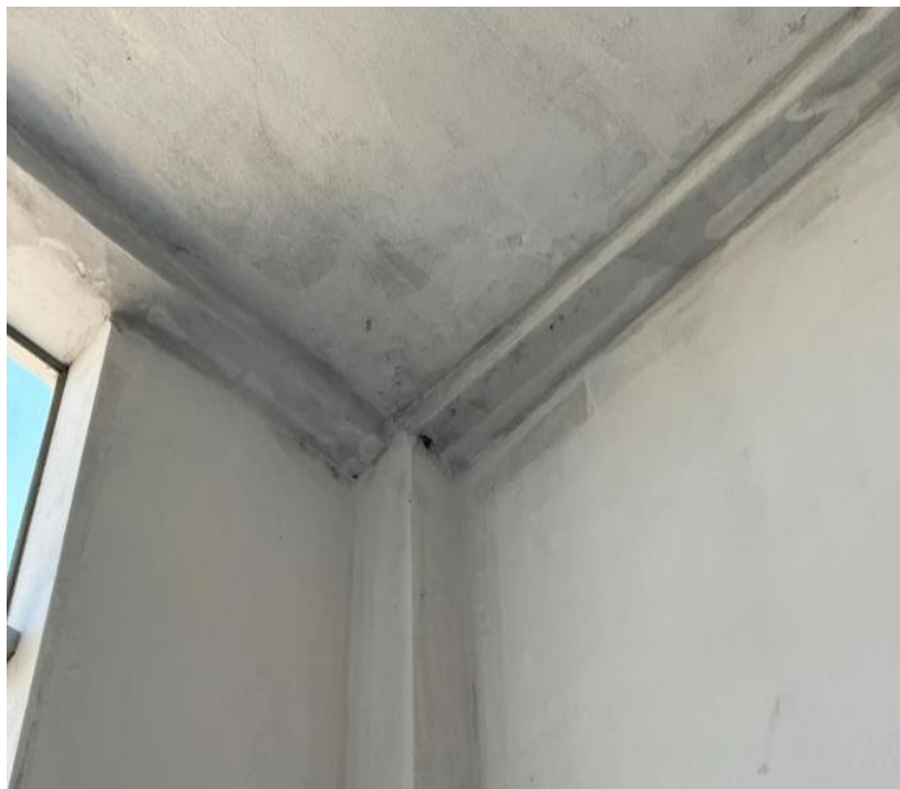
Figura 37: Fallas en la estructuración (columnas).
