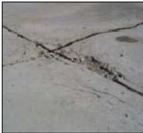
Figura N°66: Fisura de durabilidad “D” severidad alta
