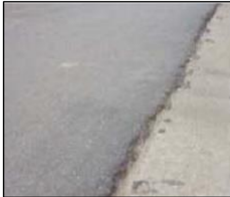
Figura N°57: Pavimento de concreto asfáltico expuesto a losa de hormigón. Severidad baja
