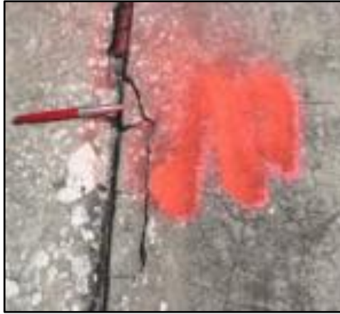
Figura N°81: Desprendimiento, severidad media
