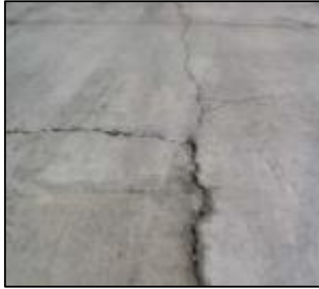
Figura N°79: Losa cuarteada, severidad alta
