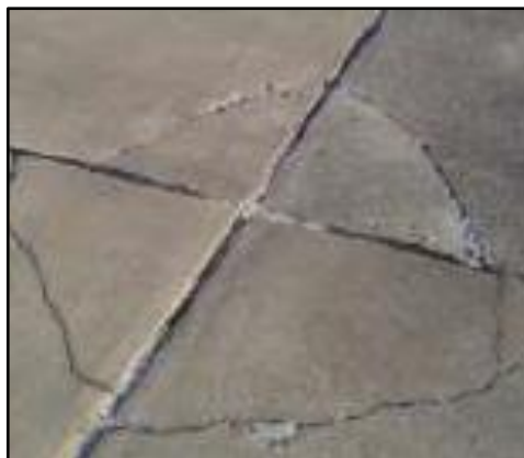
Figura N°62: Rotura de esquina, severidad media
