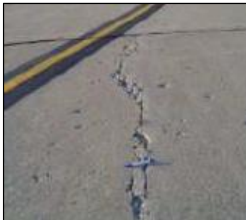
Figura N°64: Fisuras L/T/D severidad alta
