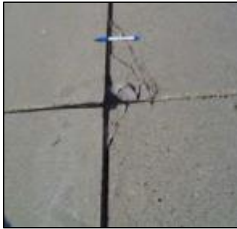
Figura N°84: Desprendimiento de esquina, severidad alta
