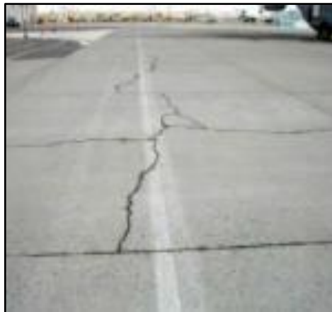
Figura N°78: Losa cuarteada, severidad media
