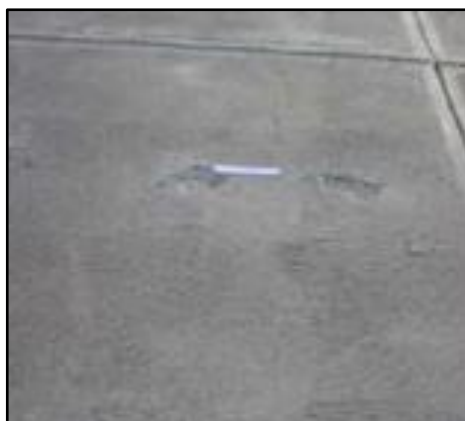
Figura N°74: Desprendimiento superficial, severidad media
