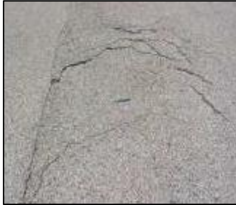
Figura N°59: Fisura por deslizamiento
