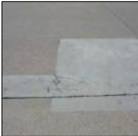
Figura N°70: Parcheo mayor de severidad media
