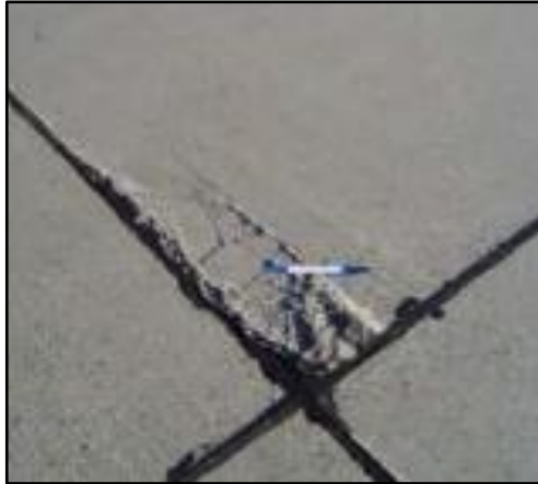
Figura N°69: Parcheo menor de severidad alta
