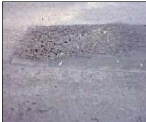
Figura N°52: Parche de severidad alta
