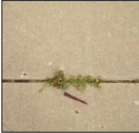
Figura N°67: Fallo en el sellado de juntas de severidad alta
