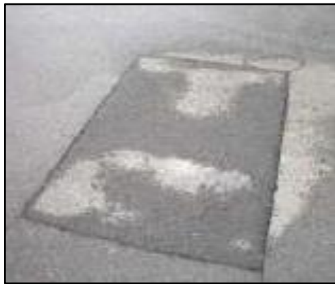
Figura N°51: Parche de severidad baja
