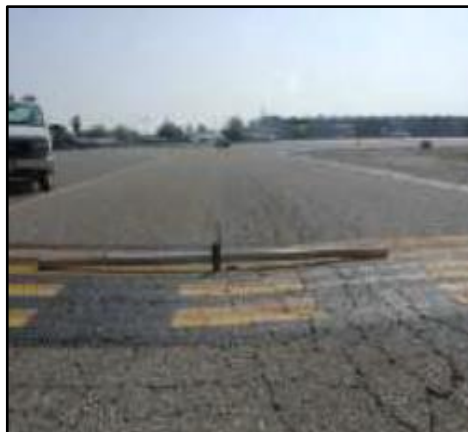
Figura N°56: Ahuellamiento de severidad alta
