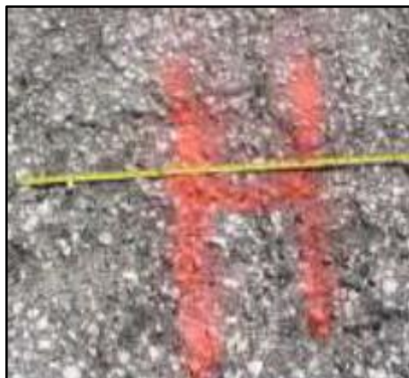
Figura N°54: Peladura de severidad alta
