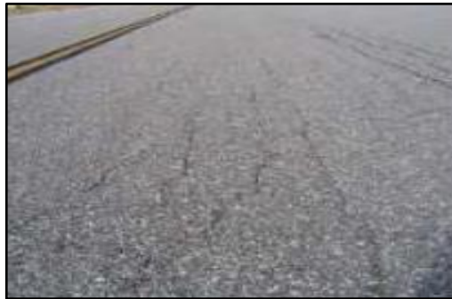
Figura N°39: Piel de cocodrilo severidad baja.
