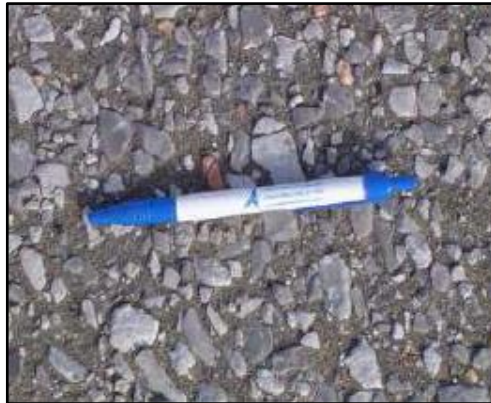
Figura N°53: Parche de severidad alta
