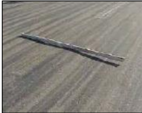
Figura N°55: Ahuellamiento de severidad media
