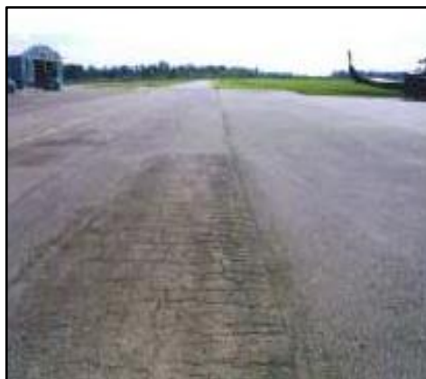
Figura N°40: Piel de cocodrilo severidad media.
