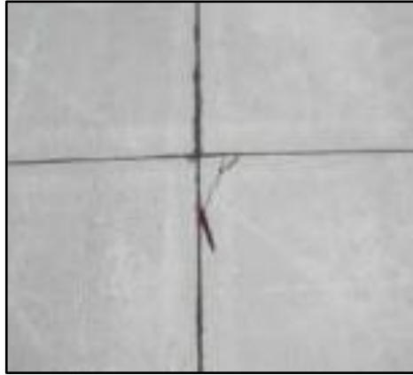
Figura N°83: Desprendimiento de esquina, severidad media
