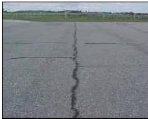
Figura N°49: Fisura por reflexión de juntas de severidad media
