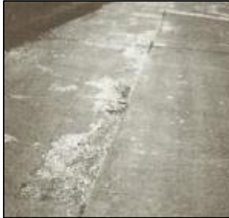
Figura N°75: Desprendimiento superficial, severidad alta
