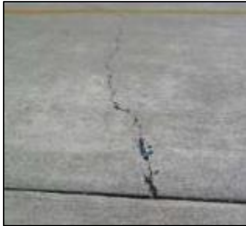
Figura N°63: Fisuras L/T/D severidad media
