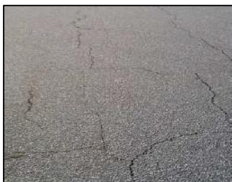
Figura N°44: Agrietamiento en bloque de severidad media
