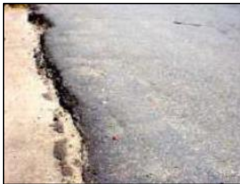
Figura N°58: Pavimento de concreto asfáltico expuesto a losa de hormigón. Severidad alta
