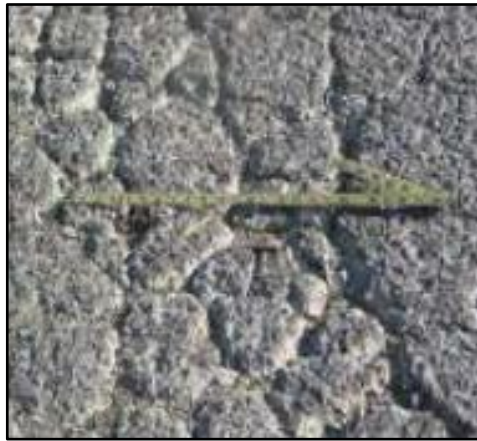
Figura N°41: Piel de cocodrilo severidad alta.
