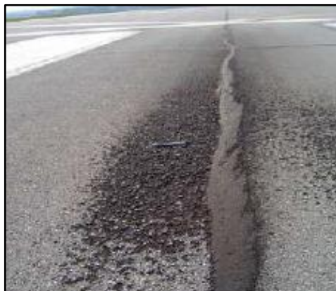
Figura N°48: Erosión por chorro de turbina
