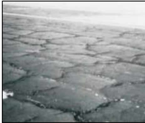
Figura N°45: Agrietamiento en bloque de severidad alta
