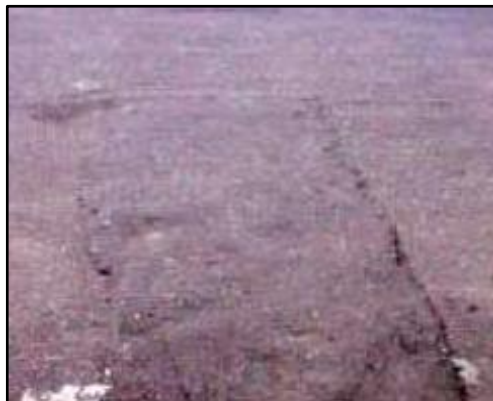
Figura N°60: Hinchamiento de severidad media
