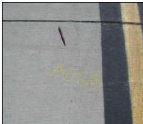
Figura N°80: Fisuras por contracción
