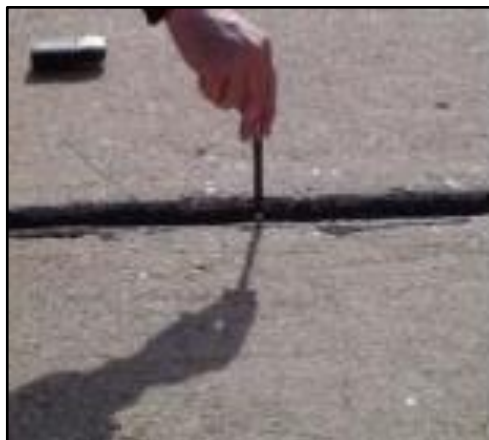
Figura N°76: Asentamientos de severidad media
