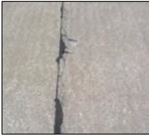
Figura N°82: Desprendimiento, severidad alta
