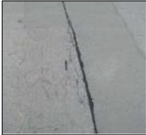
Figura N°65: Fisura de durabilidad “D” severidad media
