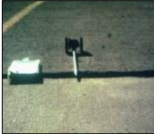
Figura N°77: Asentamientos de severidad alta
