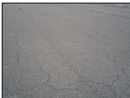
Figura N°43: Agrietamiento en bloque de severidad baja
