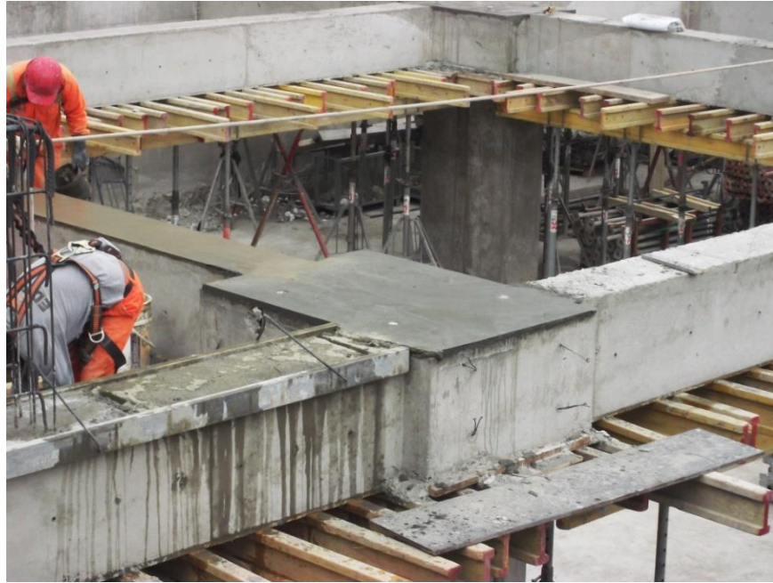
Figura 132. Fraguado de capitel inferior en nivel de aislación en entrepiso (Caso Nivel de Aislamiento)
