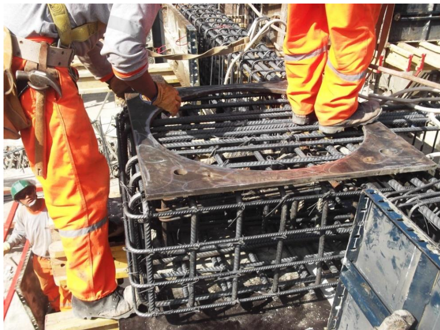
Figura 123. Habilitación de acero para capitel inferior y emplantillado de machina (Caso Nivel de Aislamiento)
