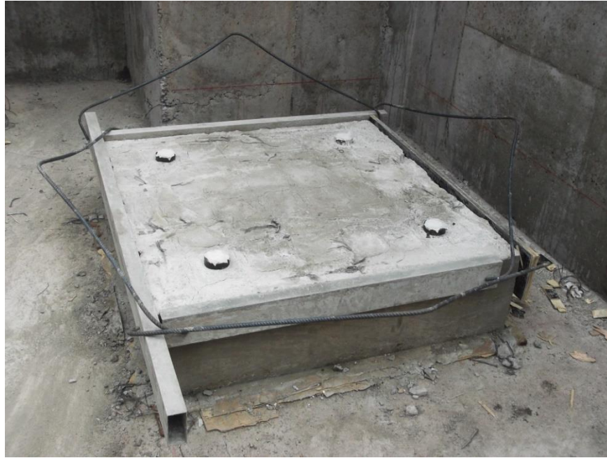
Figura 129. Fraguado de capitel inferior (Caso en zona de PIT de ascensores)
