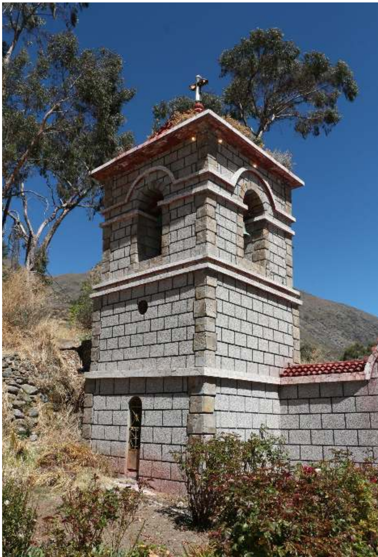
Torre de la iglesia. Nótese que la intervención aplicada no es la más aparente para un bien calificado como Patrimonio Cultural de la Nación por el INC al no haberse respetado su histórica fisonomía.
