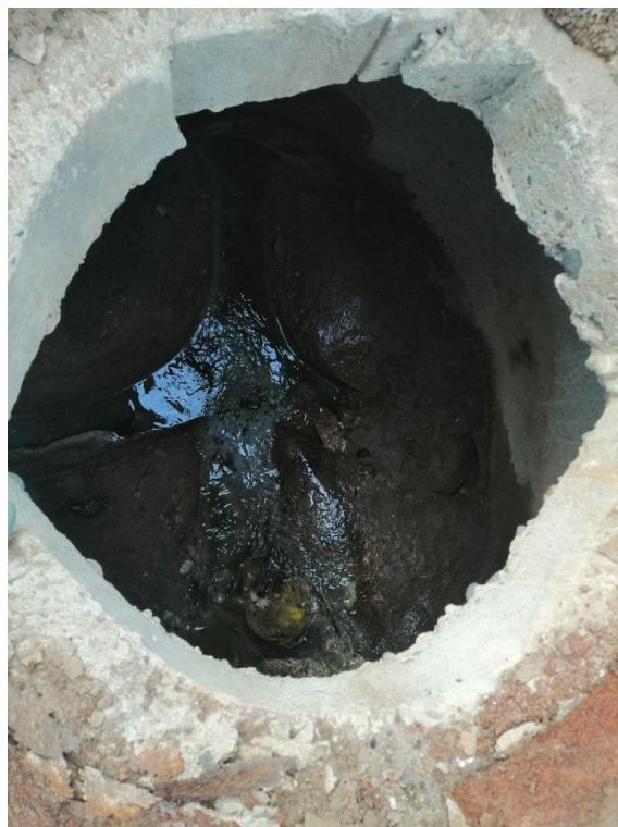
Figura N°27: Buzón colector del hospital de Picota.
