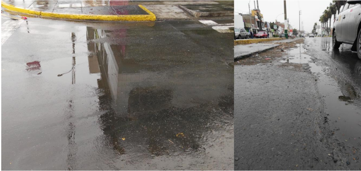
Figura 76. Agua de lluvia empozada durante la lluvia de enero en múltiples tramos de las avenidas Carlos Izaguirre y Las Palmeras en Los Olivos, Lima. 22 de enero del 2018.
