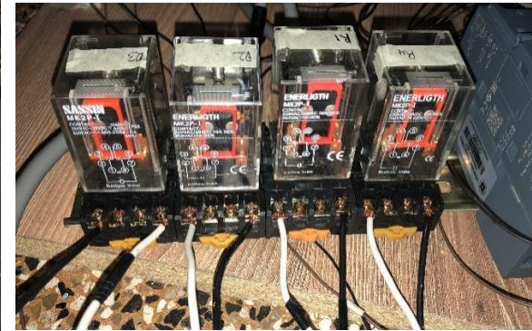
Vista conexiones Relays por delante
