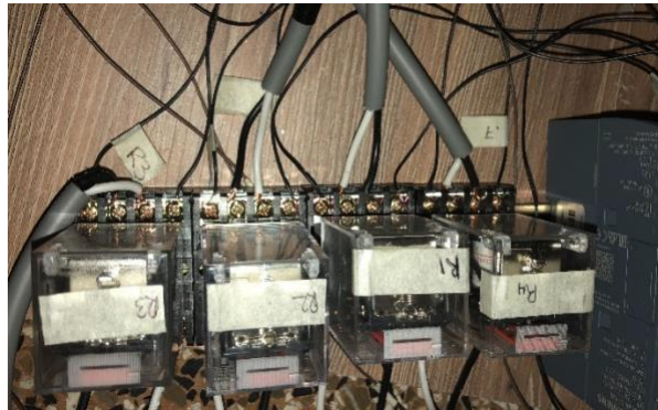
Vista de conexiones de Relays por detrás
