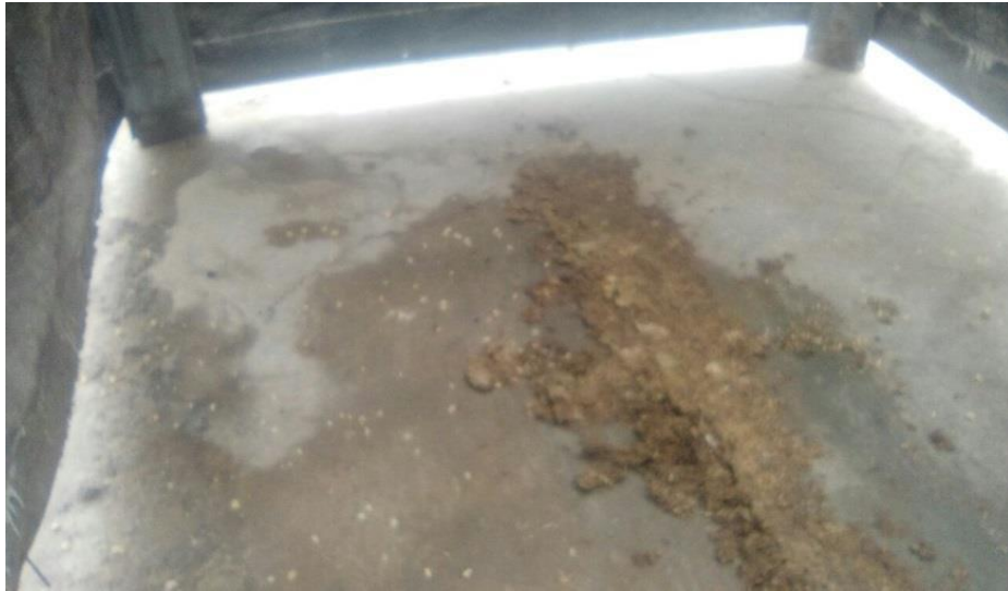
Figura 58 Desperdicios caídos del Silo
