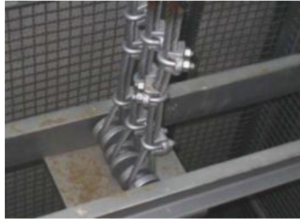
Figura 23 Extremos de los cables
