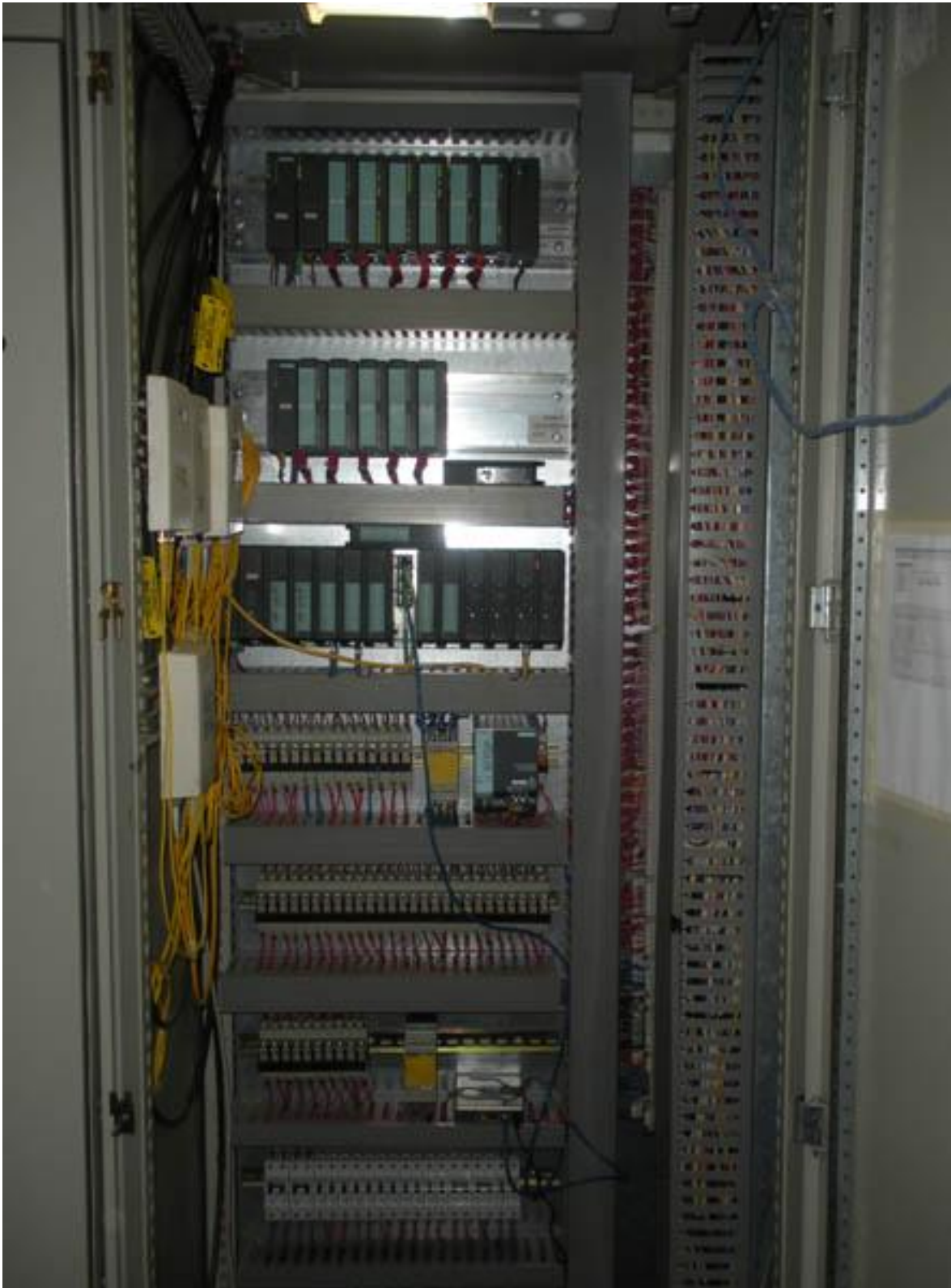
Figura D.3 Tablero de PLC Casa 1C – Switch Scalance X-400 (Fuente: Ibídem)
