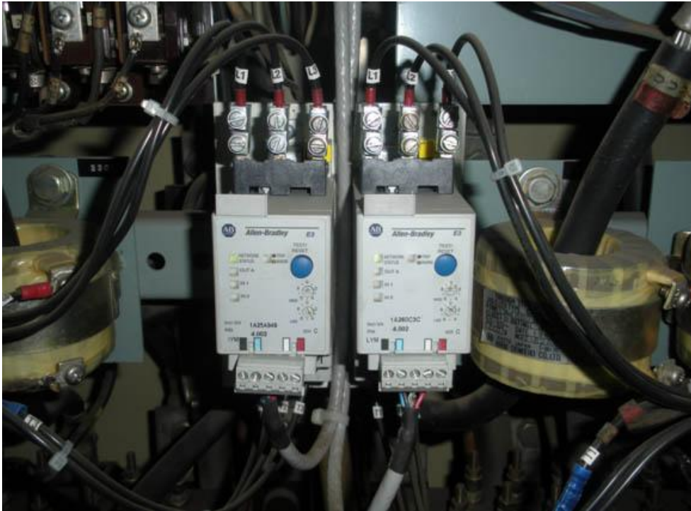
Figura D.11 Instalación Relé E3 Plus (Fuente: Ibídem)
