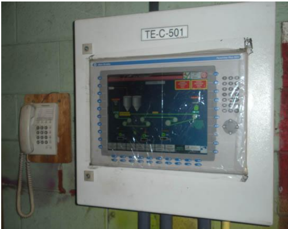
Figura D.9 Panel de Operador Allen Bradley Panel View 1500 (Fuente: Ibídem)
