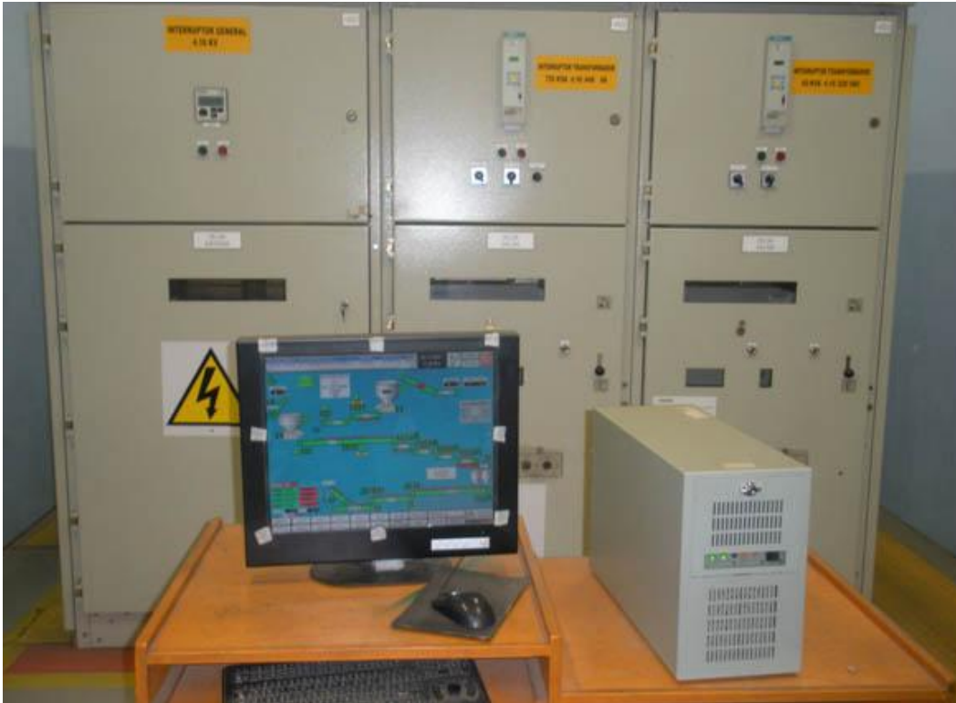
Figura D.19 Sistema SCADA Casa 1C Cabeza (Fuente: Ibídem)
