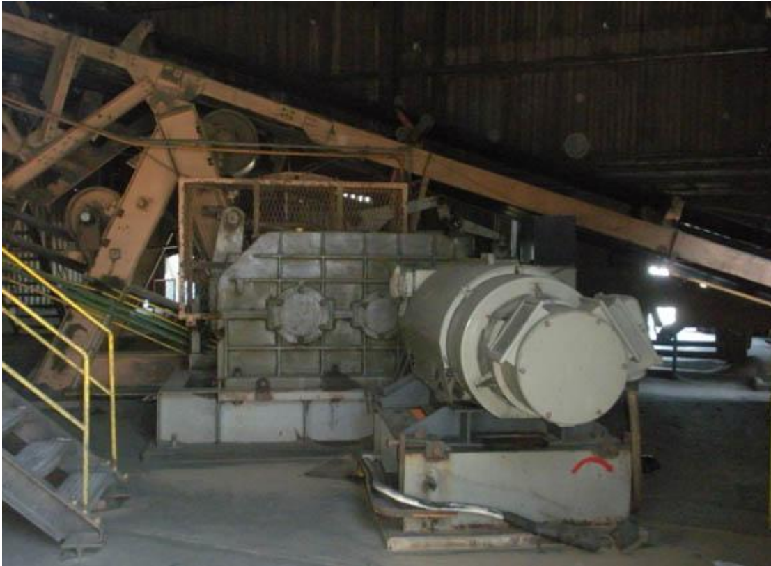
Figura D.25 Instalaciones Sistema Conveyor (Fuente: Ibídem)
