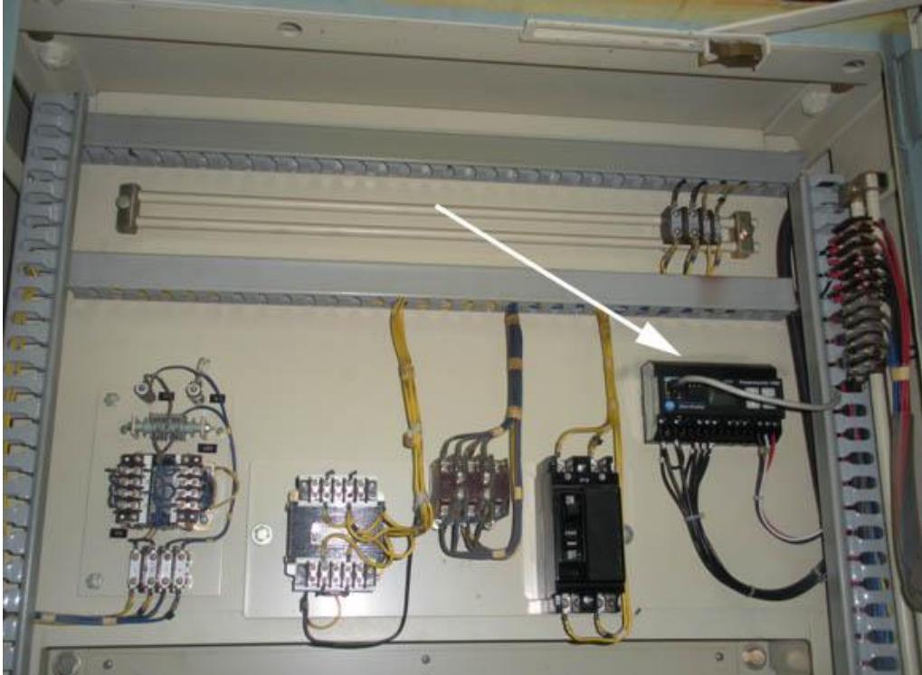
Figura D.10 Instalación Powermonitor (Fuente: Ibídem)
