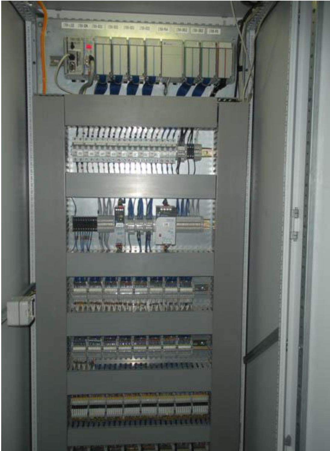
Figura D.1 Tablero de PLC Casa 7B Cabeza – CompactLogix (Ref: Elab. Prop.)
