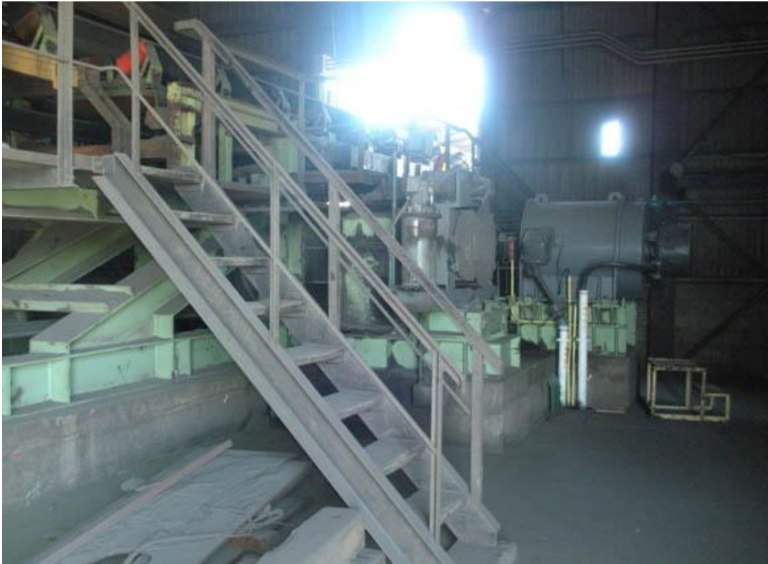
Figura D.23 Instalaciones Sistema Conveyor (Fuente: Ibídem)
