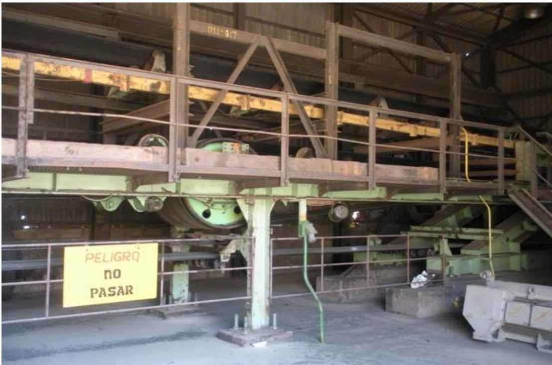
Figura D.24 Instalaciones Sistema Conveyor (Fuente: Ibídem)
