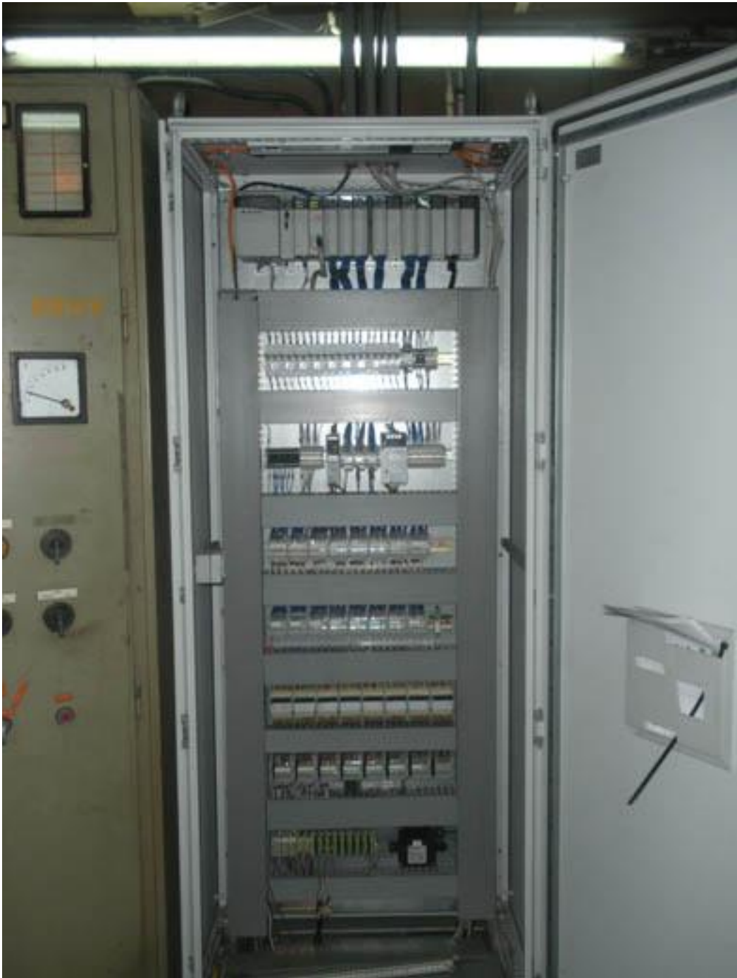
Figura D.2 Tablero de PLC Casa ControlLogix (Fuente: Ibídem)
