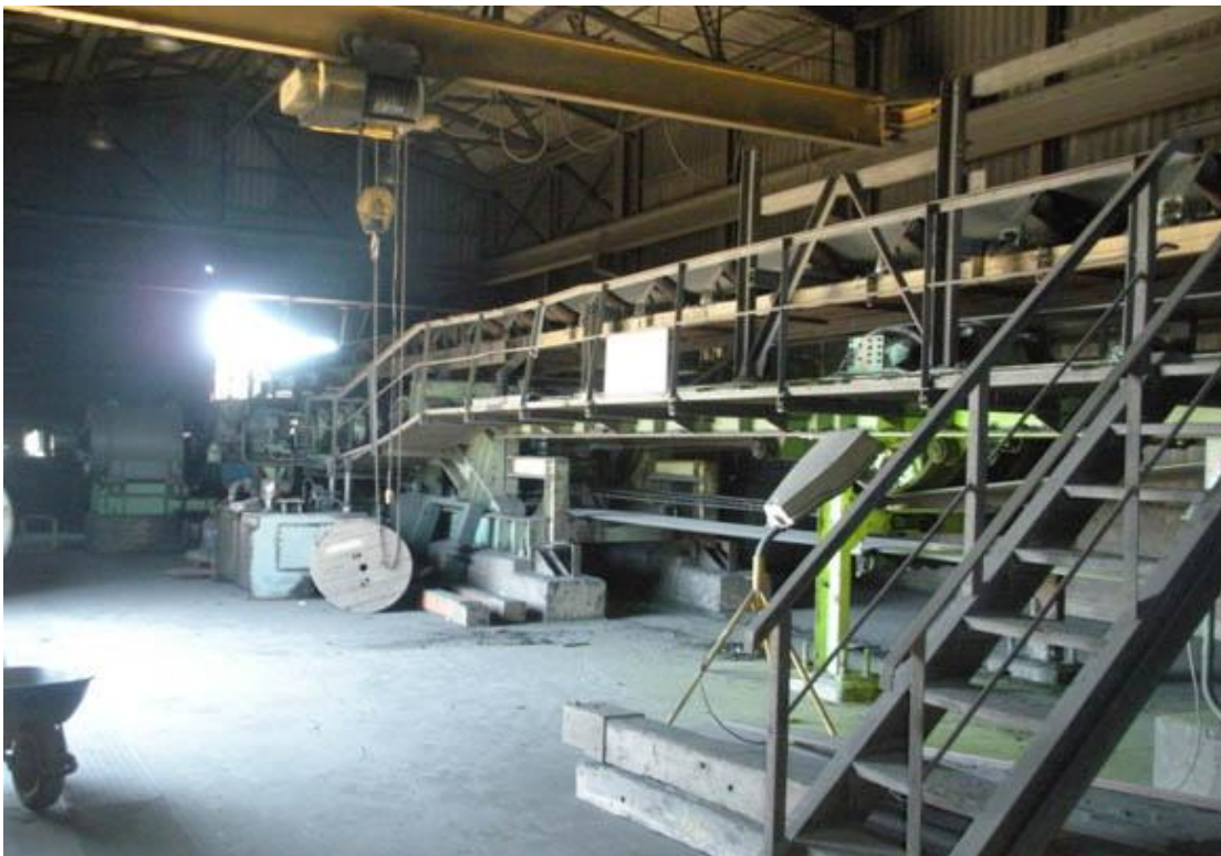
Figura D.22 Instalaciones Sistema Conveyor (Fuente: Ibídem)
