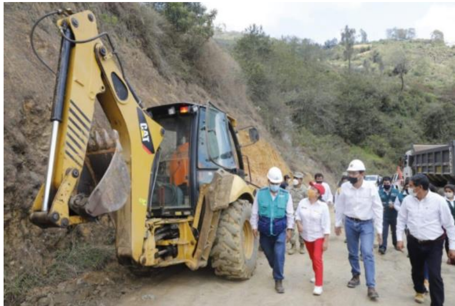
Figura N°02: Mantenimiento de caminos vecinales por la Municipalidades Provinciales de la región Huánuco.
