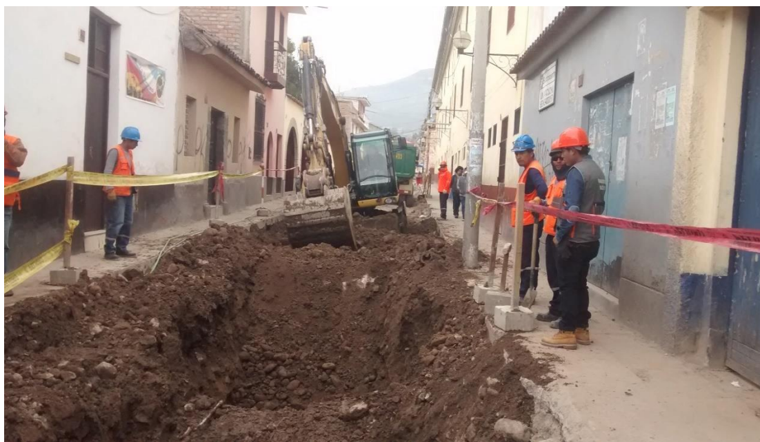
Figura 32. Excavación masiva de apertura de zanja para canal de drenaje pluvial sin previsiones de instalación de redes de desagüe. Jr. 2 de mayo.
