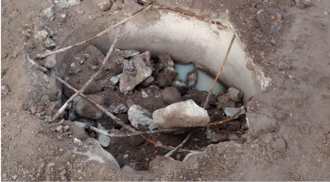
Figura 11. Buzones de desagüe colapsados con material de demolición de pavimento. Jr. Manco Cápac Fuente: Fotografía tomada del proyecto. ITEM I – IV ETAPA.
