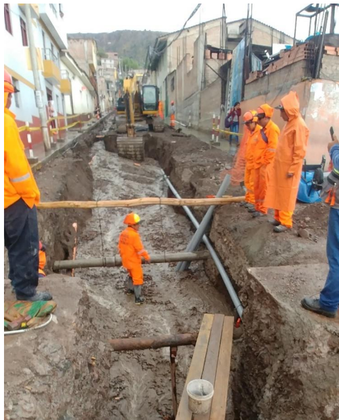
Figura 13. Zona de trabajo afectada por lluvias. Jr. Lima cuadra 03 - Drenaje pluvial ITEM III (2018)
