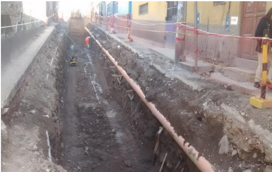
Figura 23. Tubería de desague expuesta e inestable por excavación masiva. Jr. Itana y Jr. 2 de mayo.
