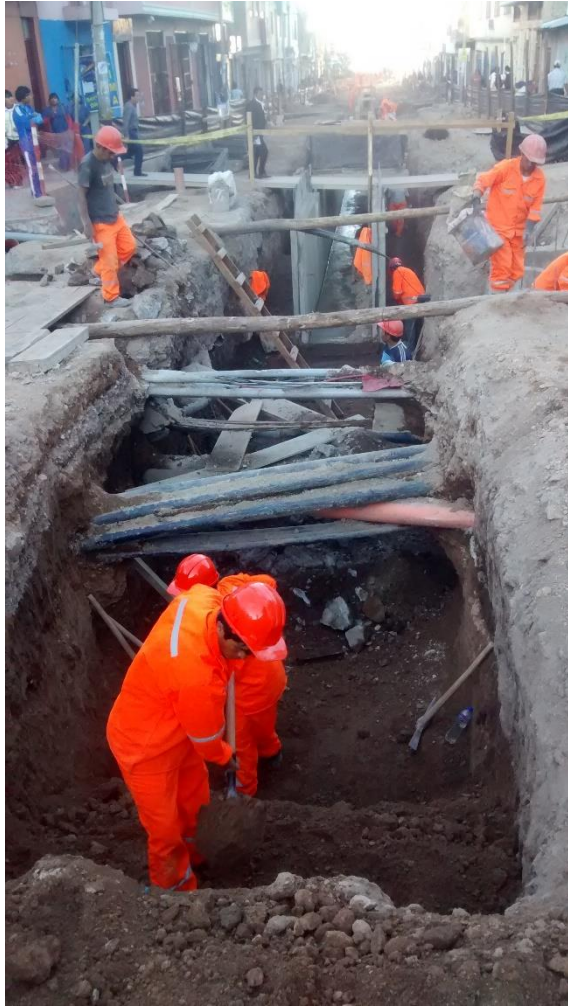
Foto 11. Interferencias no contempladas en el proyecto..
