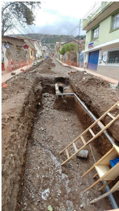
Figura 12. Zona de trabajo afectada por lluvias. Jr. Bellido cuadra 02 ITEM III. Fuente: Fotografía tomada del proyecto ITEM III.
