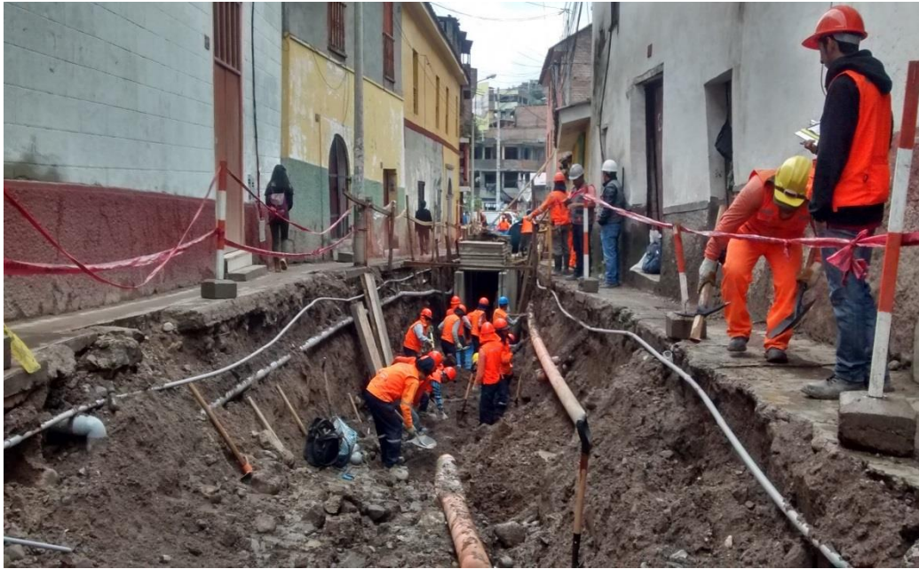
Figura 16. Limpieza de corte para canal de drenaje pluvial. Ocasionado por escorrentía de aguas pluviales en Ayacucho. Jr. Londres.
