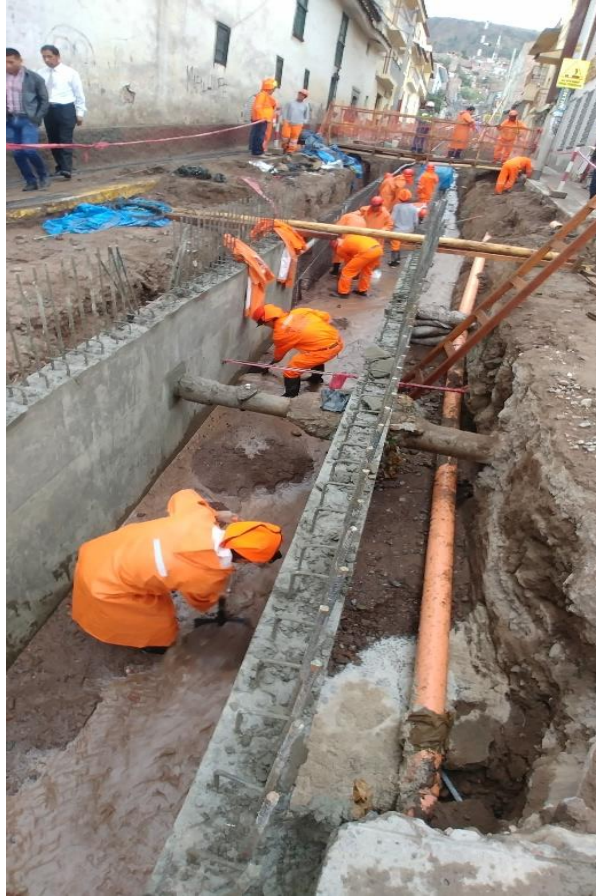
Figura 29. Redes de alcantarillado afectados por escorrentías de agua pluviales. Jr. Callao cuadra 03.
