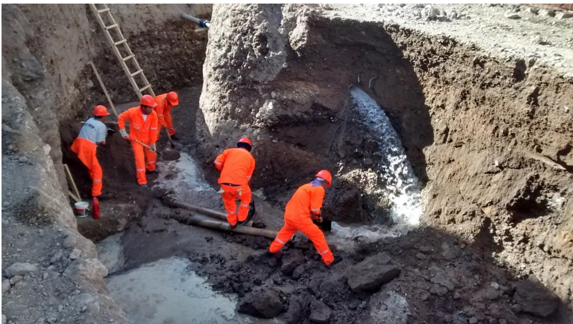
Foto 06. Rotura de tubería matriz de agua potable por debilitamiento de taludes.
