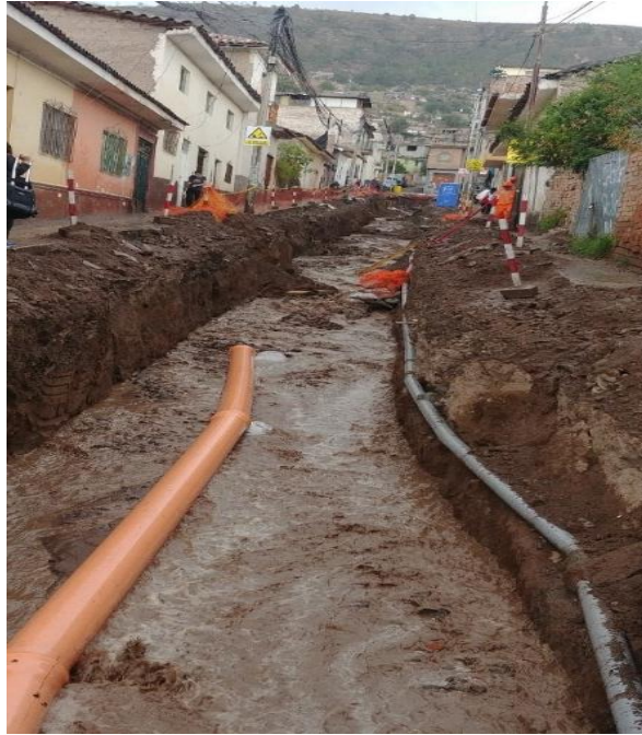
Figura 18. Tramo afectado por escorrentía de aguas pluviales. Jr. Bellido.
