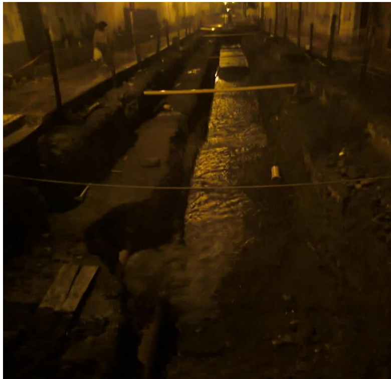
Figura 15. Canal de drenaje pluvial rebasado por las aguas pluviales en el Jr. 2 de mayo. Fuente: Fotografía tomada del proyecto ITEM II (2017)
