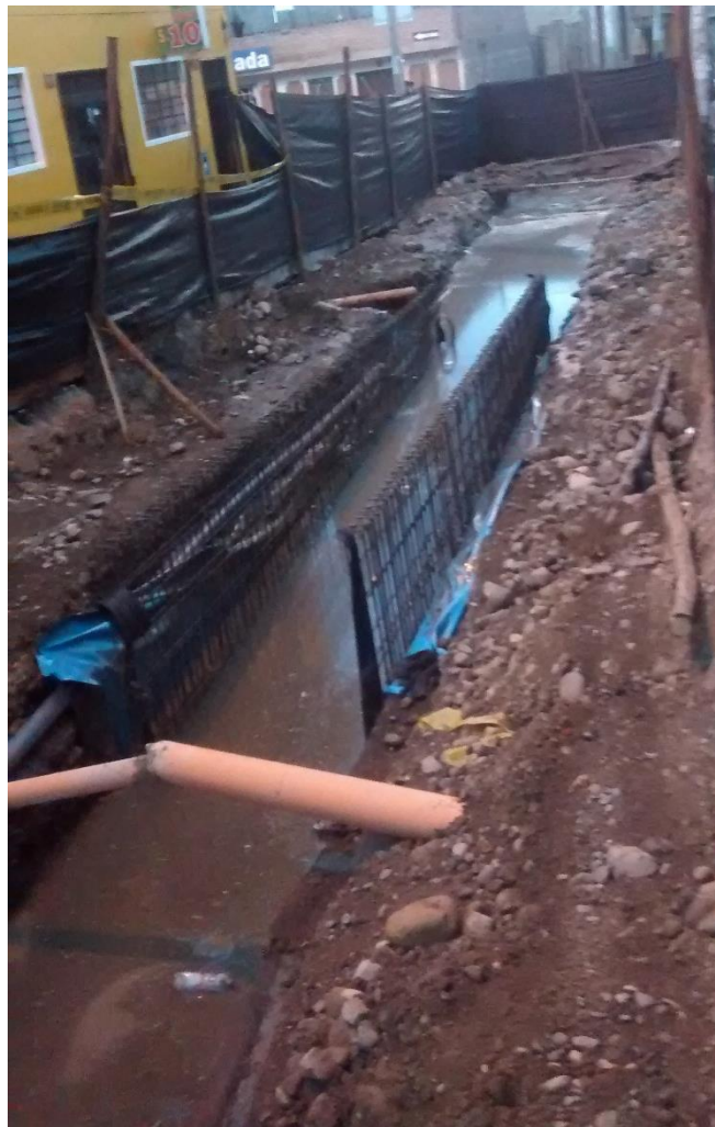
Foto 10. Estragos generados por lluvias temporales.
