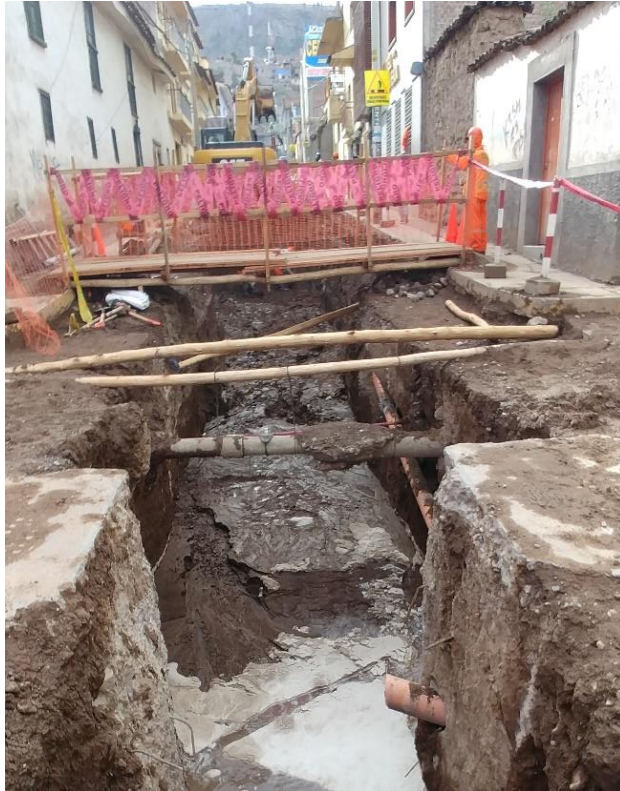
Figura 33. Colapso de redes de alcantarillado por excavación masiva para canal de drenaje pluvial
