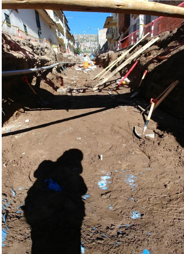
Figura 22. Resultado de afectaciones por lluvia en la conformación de base para canal pluvial L = 100 m. Jr. Callao cuadra 03.
