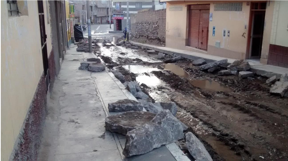
Foto 03. Eliminación de pavimento e inconvenientes con rotura de tuberías.
