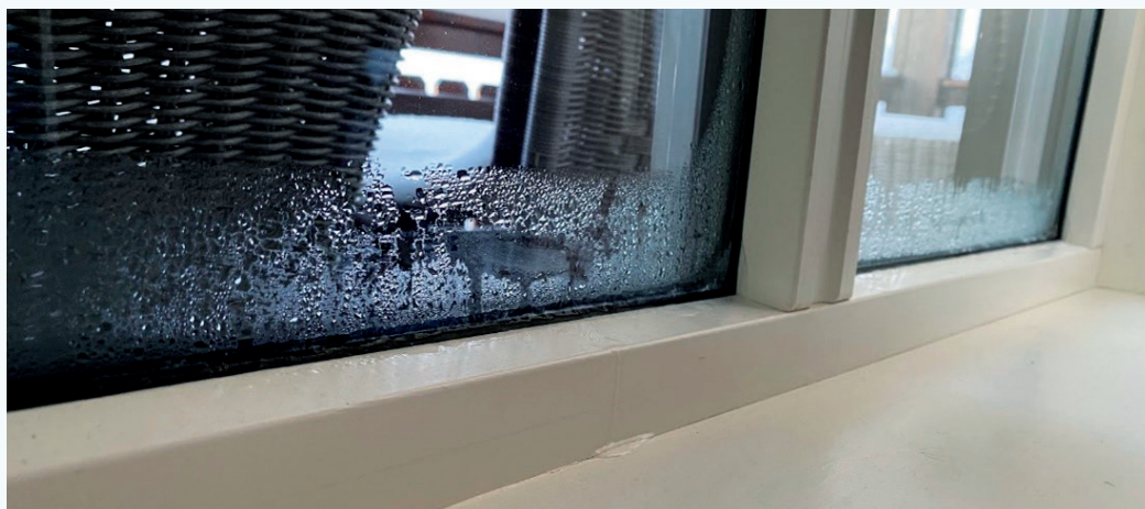
Kondens på innsiden av vindu med tolags isolerglass.
