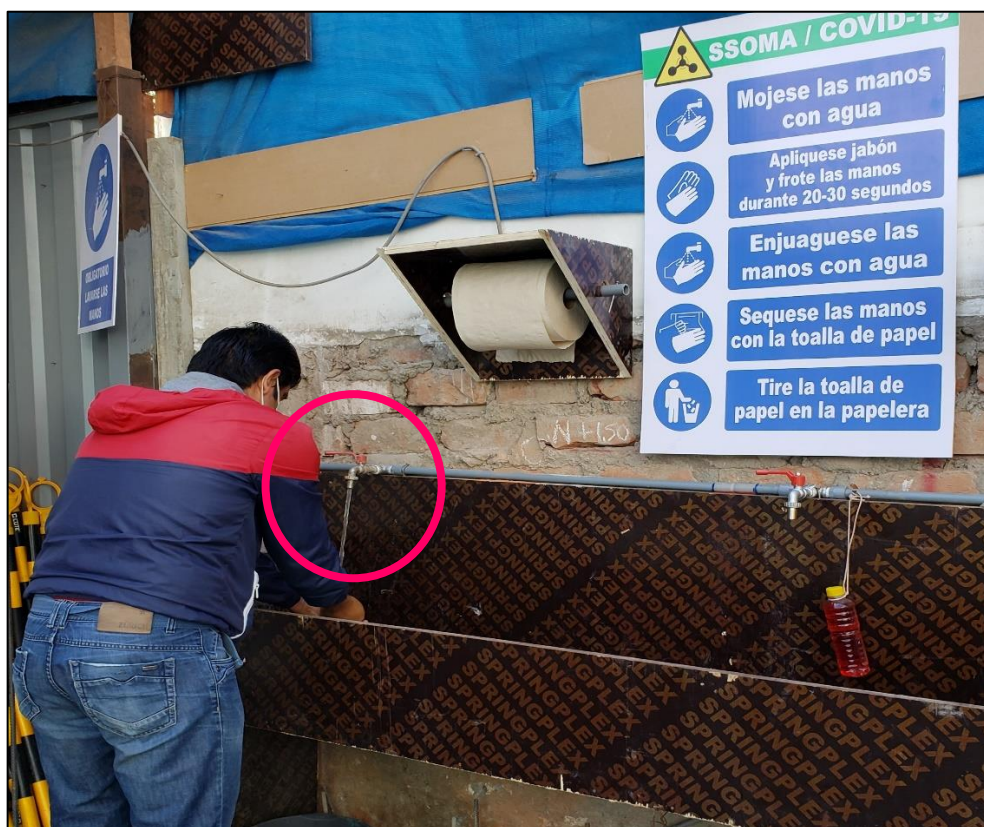
Figura 43. Mayor consumo de agua potable por cumplimiento de protocolos COVID-19 Fuente: Imagen obtenida de la obra Edificio Multifamiliar Siena de Inmobiliaria Los Fresnos S.A.C., 2020.
