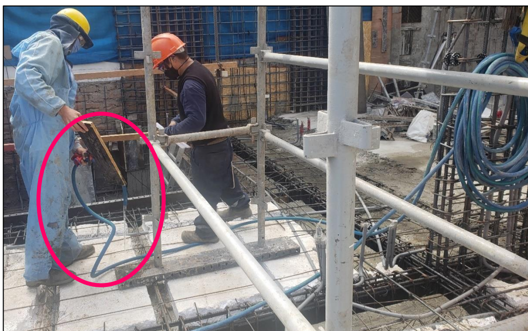
Figura 42. Consumo de agua potable Fuente: Imagen obtenida de la obra Edificio Multifamiliar Siena de Inmobiliaria Los Fresnos S.A.C., 2020.
