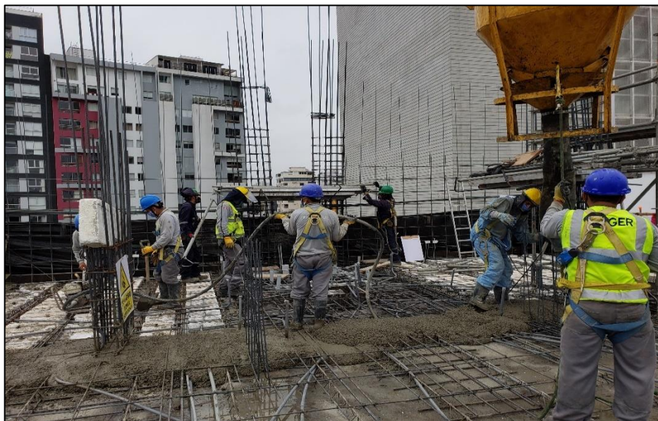
Figura 40. Consumo de piedra, agua, cemento, combustible para el vaciado de concreto en losa.
