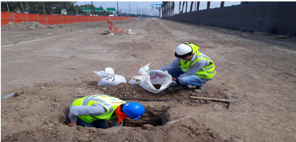
Figura 25: Obra IVD el Derby, Extracción de muestras para realización de ensayos. Fuente: Propia.
